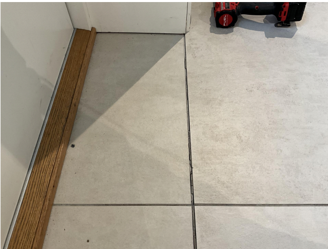
Sprekk i fuge mellom fliser ved ytterdøren.
