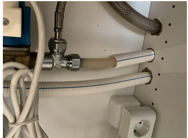
Bilde av manglende pakning mellom varerør og PEX-rør.
