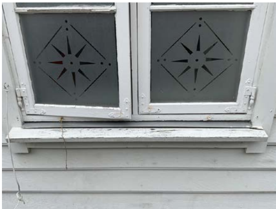
Vindu med mye slitasje og avflasket maling i 1. etasje.
