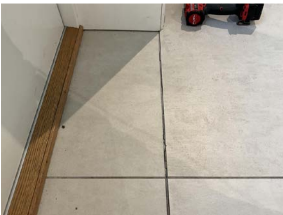
Sprekk i fuge mellom fliser ved ytterdøren.
