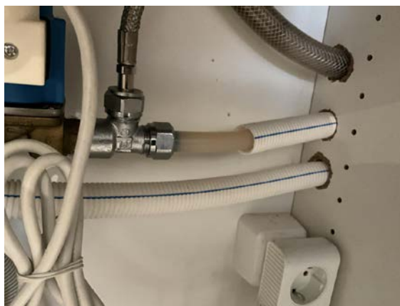
Bilde av manglende pakning mellom varerør og PEX-rør.
