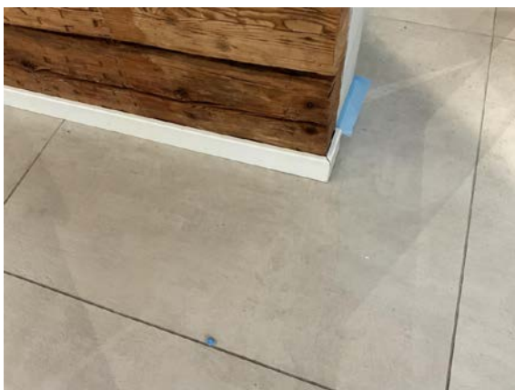
Bilde av flis med mindre sprekk og hulrom.
