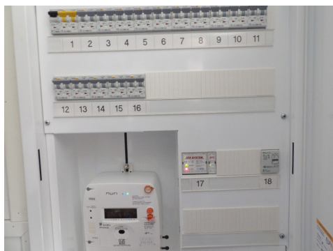
Sikringsskap i utvendig bod.
