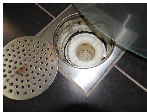
Plastsluk. i dusjsone.
