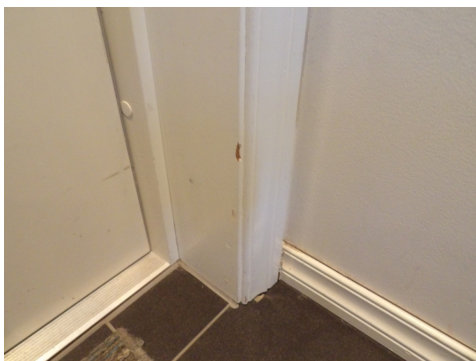
Merker på karm til ytterdør.
