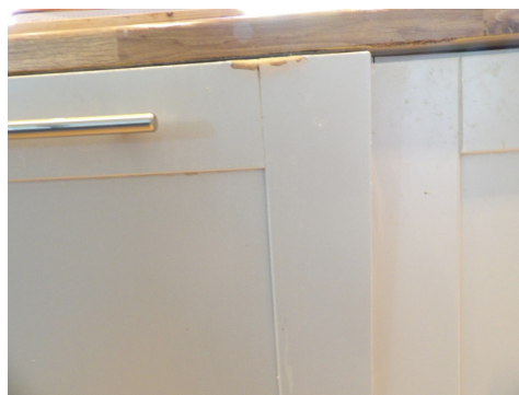
Slitasje på fronter.
