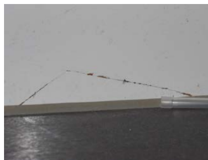
Knust flis på vegg under baderomsmøbler.
