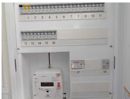
Sikringsskap i utvendig bod.
