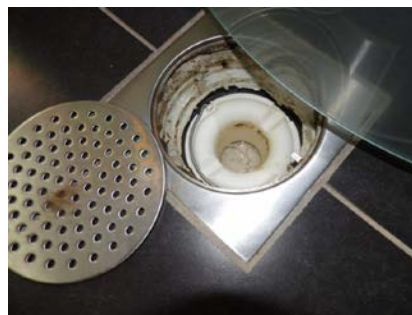
Plastsluk. i dusjsone.
