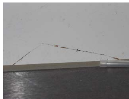
Knust flis på vegg under baderomsmøbler.
