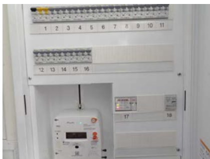
Sikringsskap i utvendig bod.
