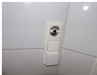
Det mangler deksel til dimmer på badet i 2. etasje.
