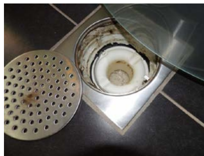
Plastsluk. i dusjsone.
