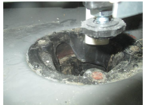
Sluk under dusjkabinett.
