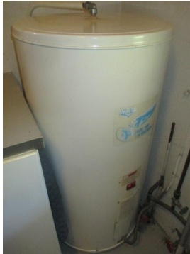
Bereider er plassert på vaskerommet.
