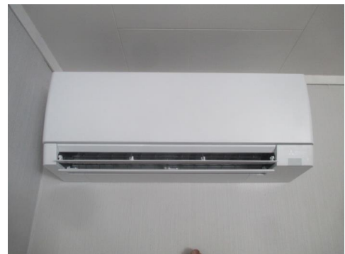
Varmepumpe i stue.
