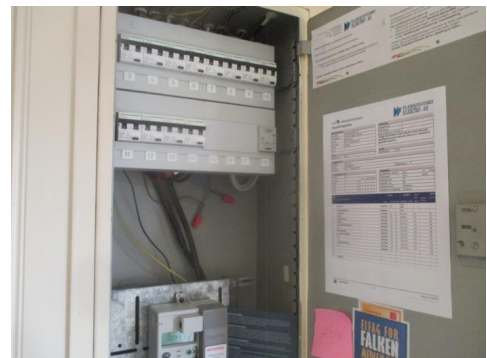
Sikringsskapet er plassert i vindfang.
