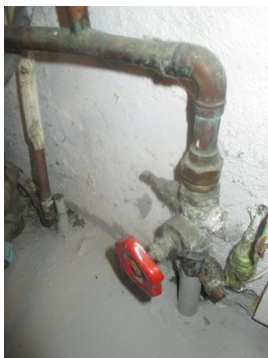
Innvendig stoppekran på vaskerommet.
