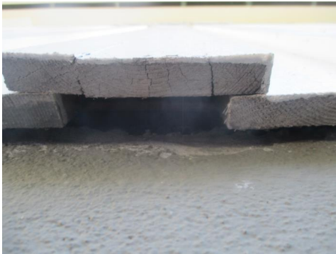
Bunnen av kledningen i mot grunnmur.
