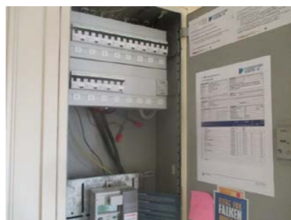
Sikringsskapet er plassert i vindfang.
