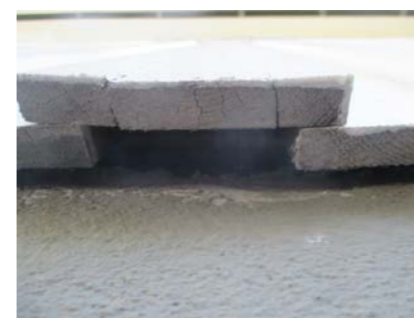
Bunnen av kledningen i mot grunnmur.
