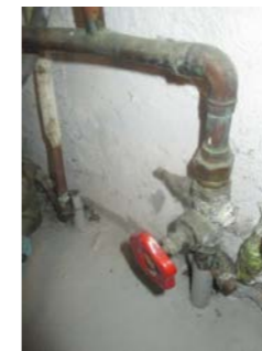
Innvendig stoppekran på vaskerommet.
