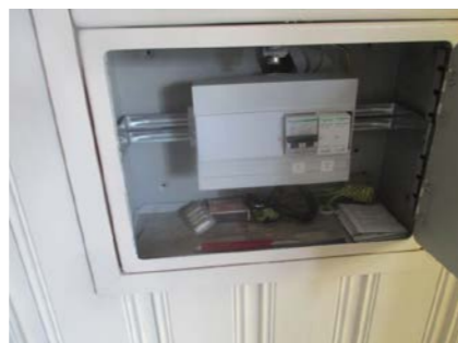
Skap for hovedsikringer.
