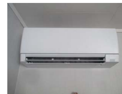
Varmepumpe i stue.
