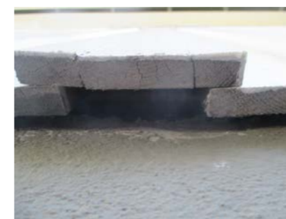
Bunnen av kledningen i mot grunnmur.
