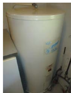
Bereder er plassert på vaskerommet.
