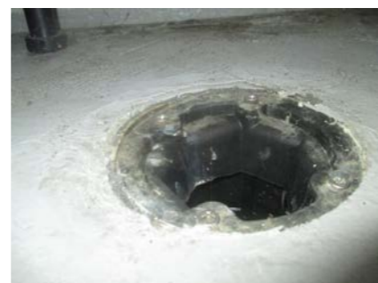
Sluk under innredningen.
