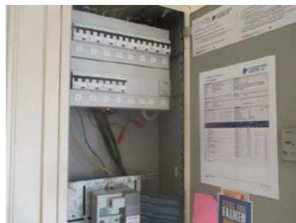
Sikringsskapet er plassert i vindfang.
