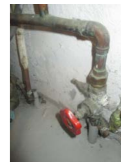
Innvendig stoppekran på vaskerommet.
