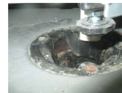
Sluk under dusjkabinett.
