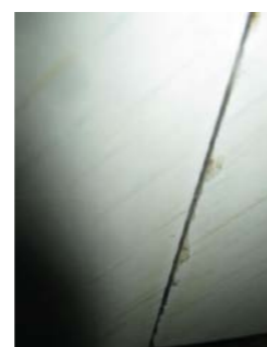
Plater har svullet noe i skjøter.
