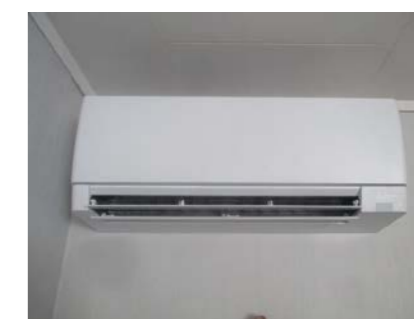
Varmepumpe i stue.
