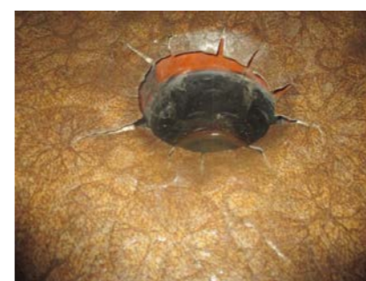
Belegget er ikke klemt i sluke.
