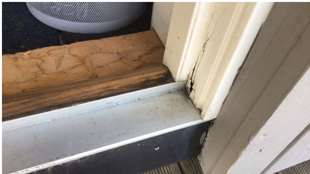
Fukt skader i dørkarm i bod
