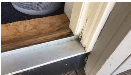
Fukt skader i dørkarm i bod
