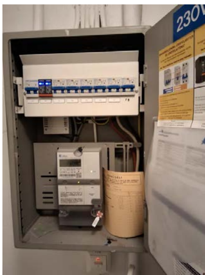
Sikringsskap med automatsikringer er plassert på bod.
