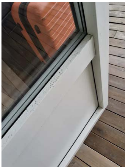
Det registreres kloremerker på innsiden av balkongdør.
