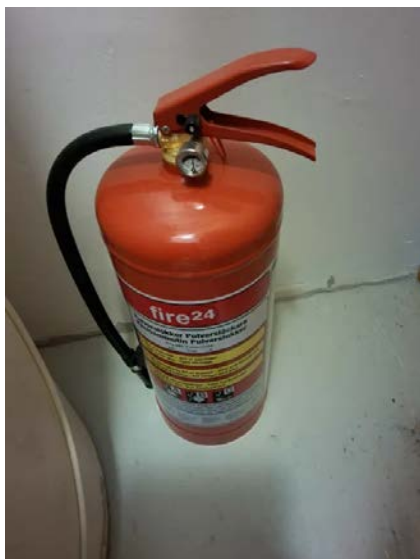
Brannslukningsapparat er plassert på bod.
