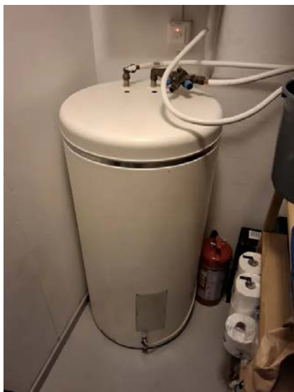
Varmtvannsbereider er plassert på bod.
