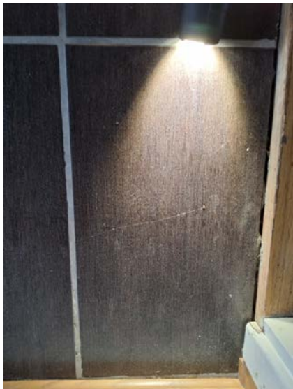
Bilde viser sprekt gulvflis.
