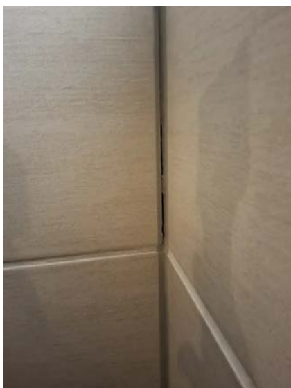
Sprekker i elastiske fuger i hjørnet i dusjnisen.
