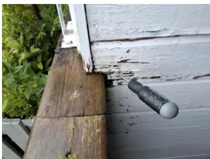
Det registreres råteskader i levegg.
