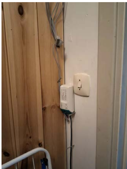
Strømtilførsel til downlights på bad.
