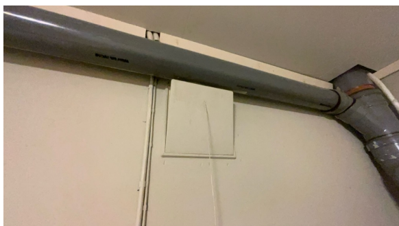
Eksempel på montert ventil i vegg.
