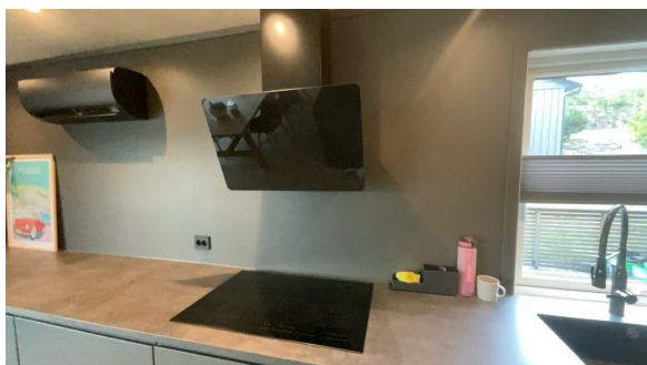
Montert avtrekk over steketopp.
