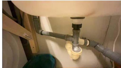
Del av rør til avløp.
