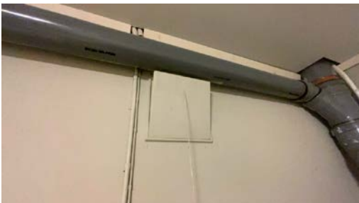
Eksempel på montert ventil i vegg.
