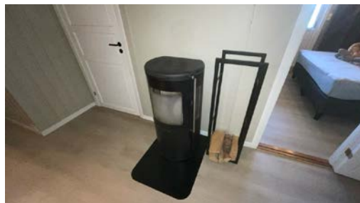
Montert ovn i underetasjen
