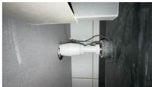
Del av rør til vann.
