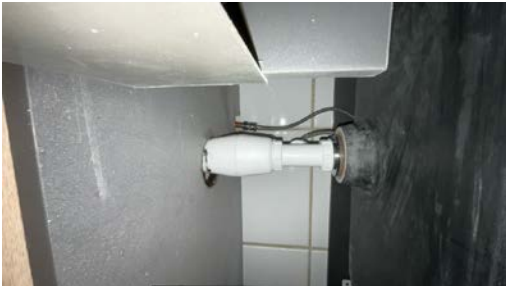
Del av rør til avløp.
