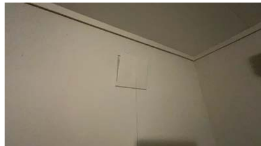
Eksempel på montert ventil i vegg.
