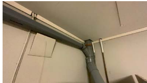
Del av rør til avløp.
