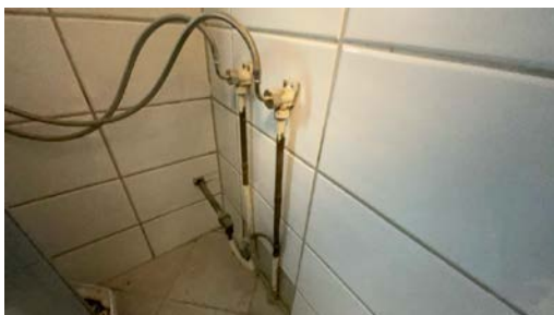
Del av rør til vann.
