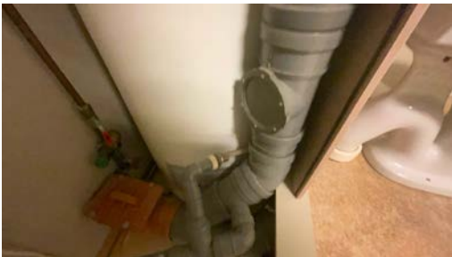
Del av rør til avløp.
