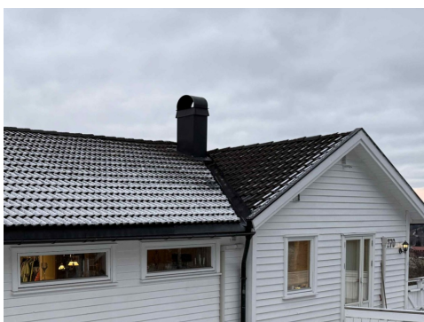
Bildet viser pipe med manglende takstige.
