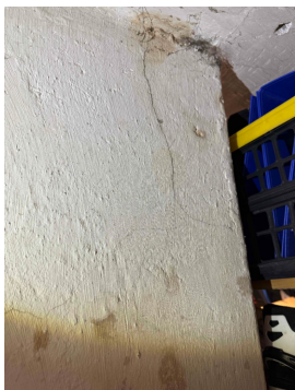
Bildet viser sprekk/riss i pipe i kjelleren
