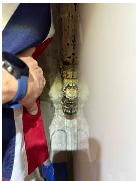
Bildet viser avløpsrør av støpejern.
