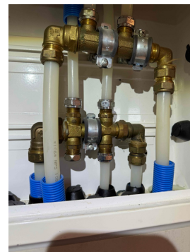
Bildet viser rørskap uten drenering.
