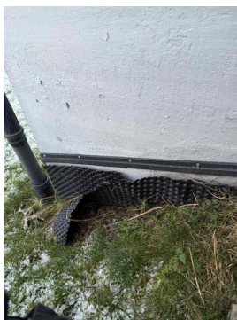
Bildet viser grunnmursplast som har seget.
