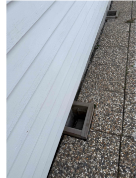
Bildet Bilder viser manglende toppliste.
