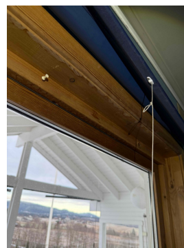
Bildet viser fuktskjolder i vinduskarmen på soverommet mot trapperommet.
