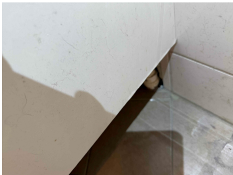
Bildet viser påbegynt svelling på servantskapet.
