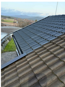
Bildet viser taket med manglende snøfangere.
