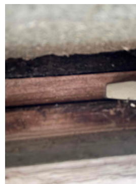
Bildet viser underkant av kledning med ingen lufting.
