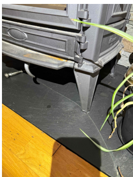
Bildet viser sprukket plate under vedovnene.
