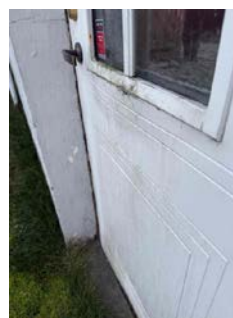
Bildet viser døren til kjelleren med svelleskader.
