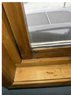
Bildet viser tegn til svertesopp og kondens.
