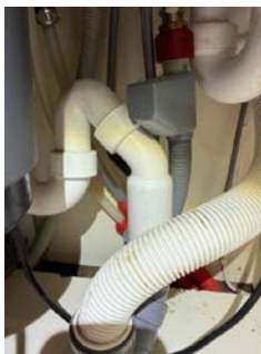
Bildet viser varerør uten tettemuffe.
