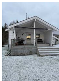
Bildet viser trapp uten rekkverk til veranda utenfor soverom.
