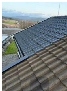
Bildet viser taket med manglende snøfangere.
