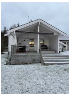
Bildet viser rekkverk med manglende glassfelt.
