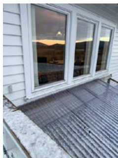
Bildet viser vindu med utvendig skade på karm, samt liten klaring mellom vannbrett og utvendig omramming.
