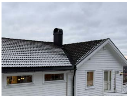
Bildet viser pipe med manglende takstige.
