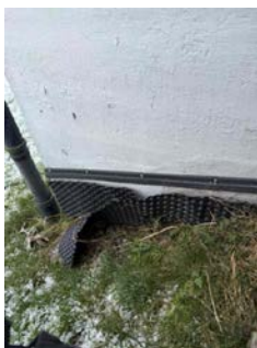
Bildet viser grunnmursplast som har seget.
