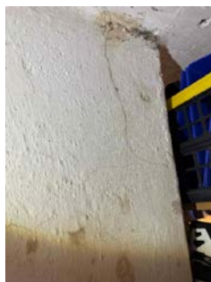
Bildet viser sprekk/riss i pipe i kjelleren
