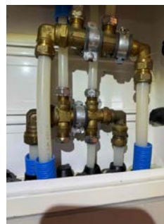
Bildet viser rørskap uten drenering.
