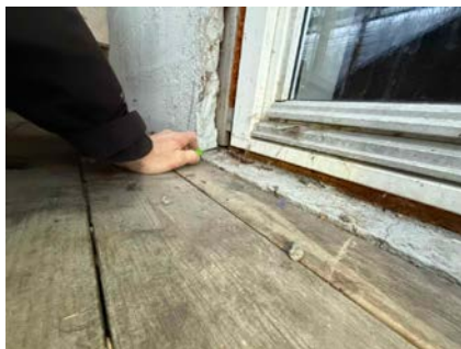
Bildet viser kjellervinduet med synlig monteringskum.
