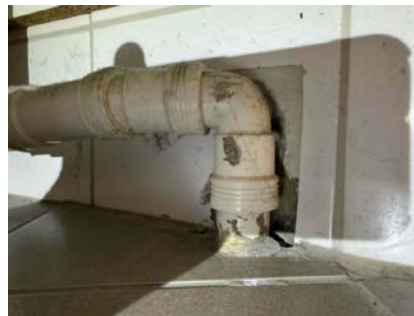
Bilet viser avløpsrøret fra servanten.
