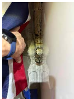
Bildet viser avløpsrør av støpejern.
