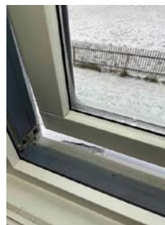
Bildet sier kondensering på vinduet.
