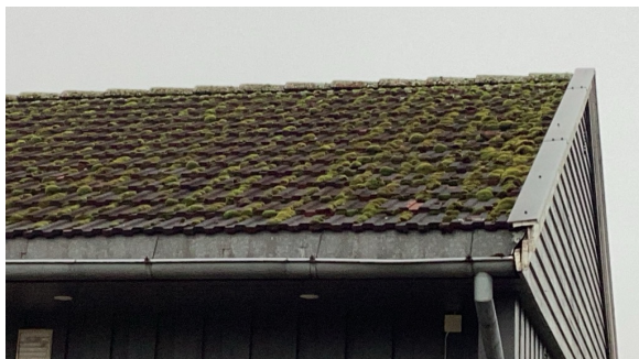
Kraftig mosevekst på taktekingen.
