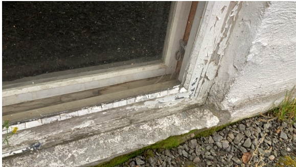
Eksempel på slitasje på kjellervindu
