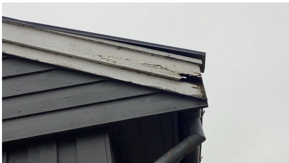
Råte på vindski.
