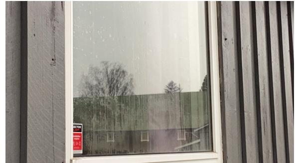
Flere vinder i 1. etasje har punktert glass.
