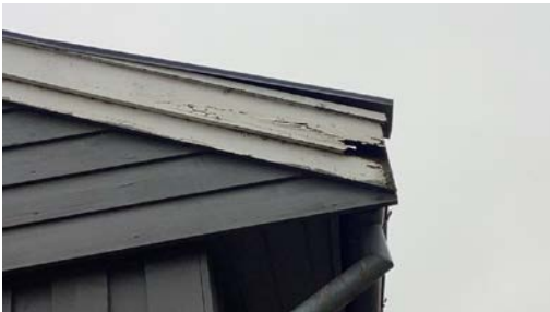
Råte på vindski.
