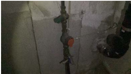
Vannmåler og stoppekran i kjeller.
