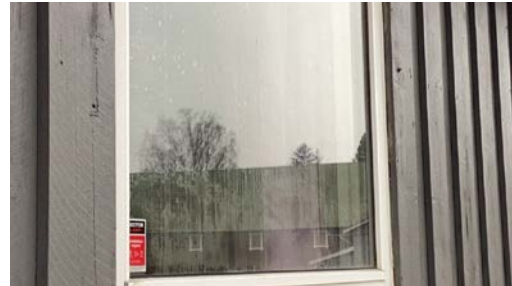
Flere vinder i 1. etasje har punktert glass.
