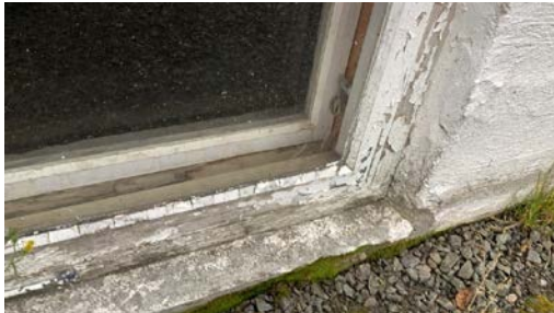
Eksempel på slitasje på kjellervindu
