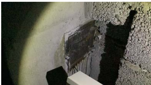
Sotluke i kjeller.
