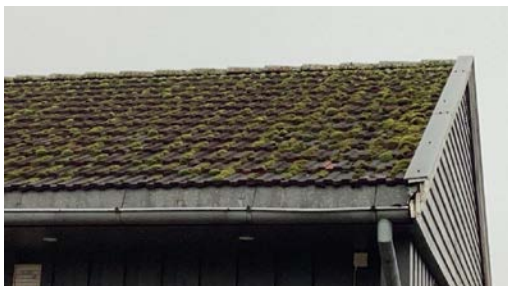
Kraftig mosevekst på taktekingen.
