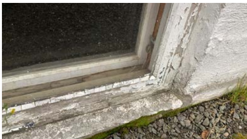
Eksempel på slitasje på kjellervindu
