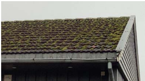
Kraftig mosevekst på taktekingen.
