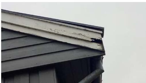
Råte på vindski.
