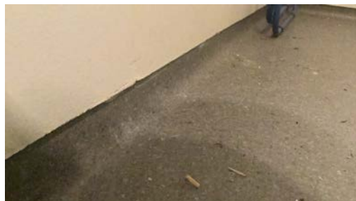
Ikke overlapping mellom gulvbelegg og veggplater.
