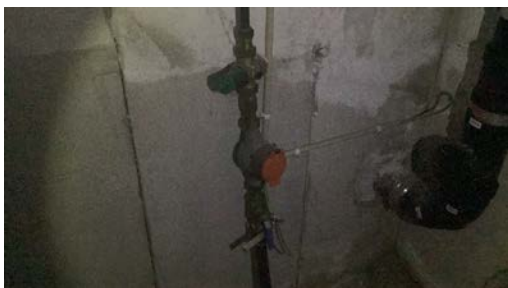
Vannmåler og stoppekran i kjeller.
