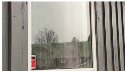
Flere vinduer i 1. etasje har punktert glass.
