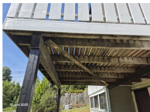
Bildet viser bjelkelaget til balkong. Vedlikehold trengs.
