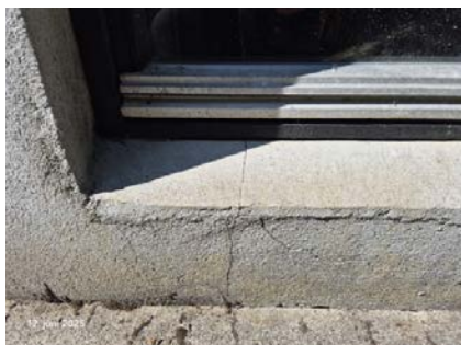
Mindre sprekker kan sees på bildet.
