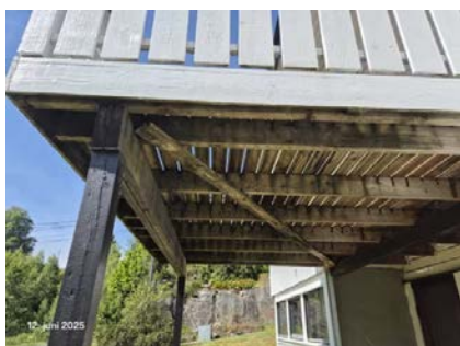
Bildet viser bjelkelaget til balkong. Vedlikehold trengs.
