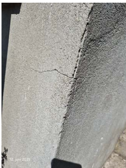
Mindre sprekker kan sees på bildet.
