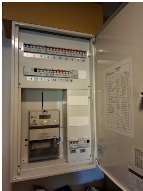
Sikringsskap med automatsikringer.
