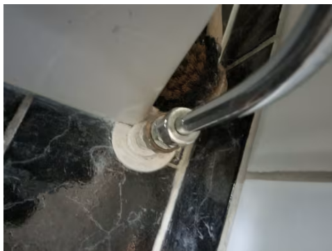
Rørgjennomføringer er tettet med silikon eller lignende.
