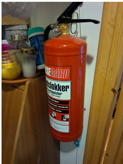
Eldre brannslukningsapparat plassert i teknisk rom.
