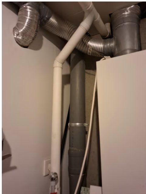
Synlige avløpsrør av plast i boligen.
