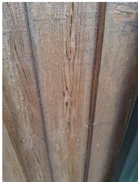
Kledningen er stedvis værslitt.
