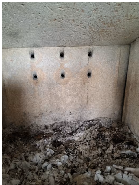
Det registreres en sprekke i ildfast stein i ovnen.
