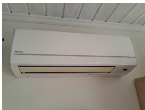
Varmepumpe i stue i første etasje.
