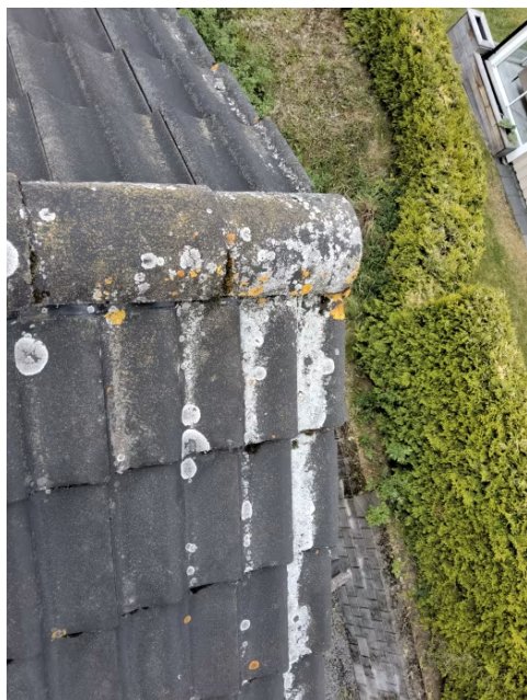
Det registreres noe mosevekst på taksteinen.
