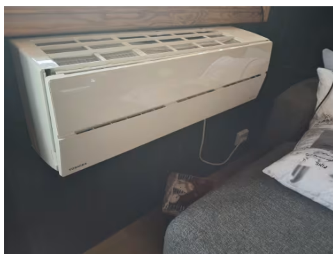
Varmepumpe i stue i underetasje.
