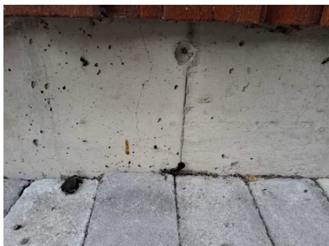
Det er mindre riss i grunnmuren.
