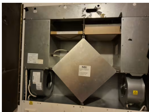
Ventilasjonsaggregat er plassert i teknisk rom.
