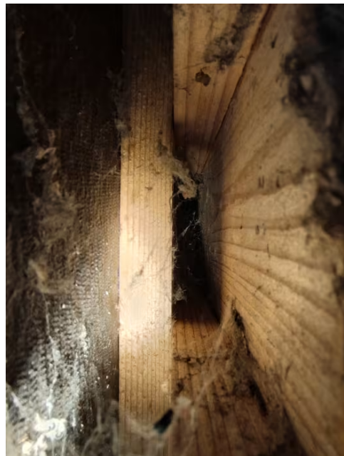
Det er ikke etablert musesperre bak kledningen.
