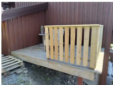
Terrassen mangler trapp med rekkverk.
