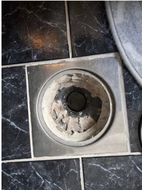
Overgang mellom sluk og membran er uoversiktlig.
