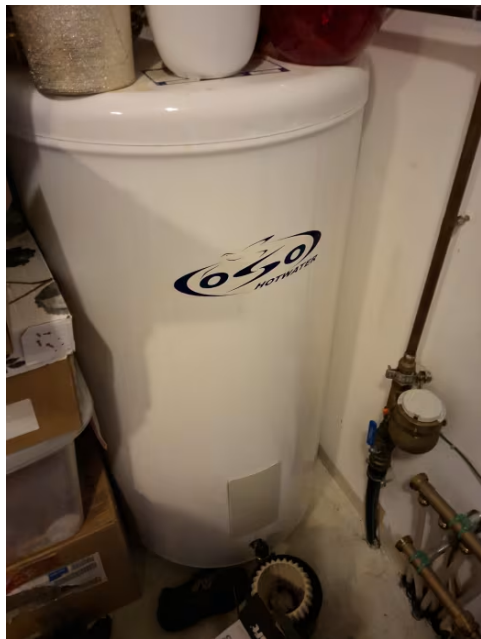
Varmtvannsbereder er plassert i teknisk rom.
