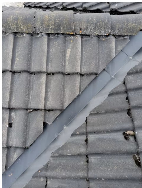
Det registreres enkelte knekte takstein ved gradrenne.
