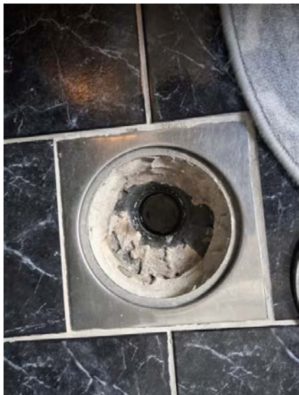
Overgang mellom sluk og membran er uoversiktlig.
