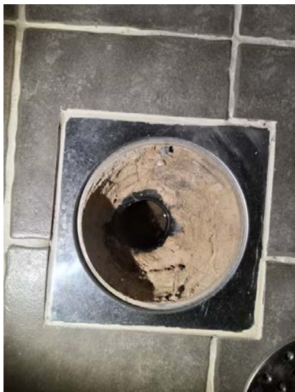
Utførelse av overgang mellom sluk og membran er uoversiktlig.
