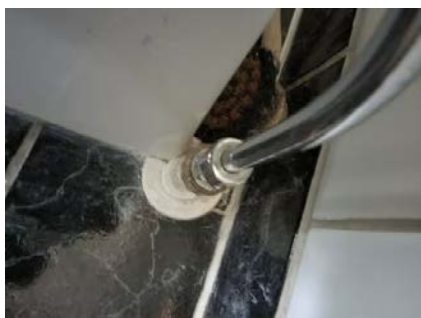
Rørgjennomføringer er tettete med silikon eller lignende.
