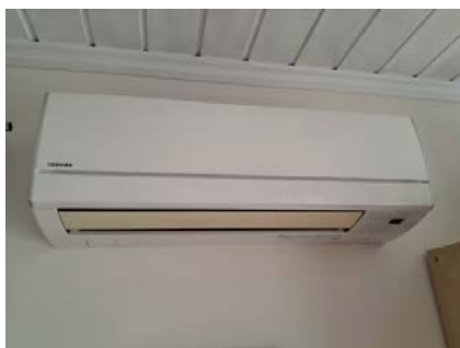
Varmepumpe i stue i første etasje.
