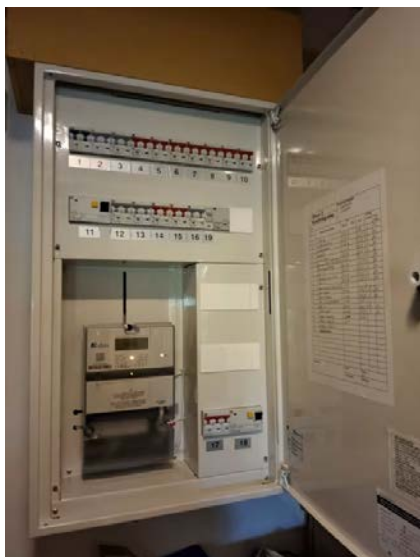
Sikringsskap med automatsikringer.
