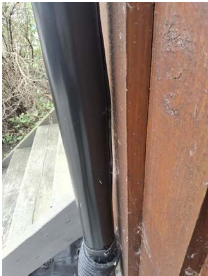
Det registreres buling på nedløpsrør.
