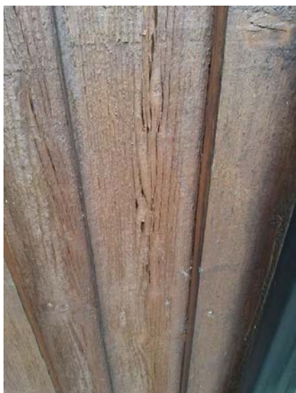
Kledningen er stedvis værslitt.
