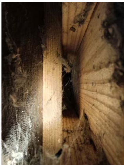
Det er ikke etablert musesperre bak kledningen.
