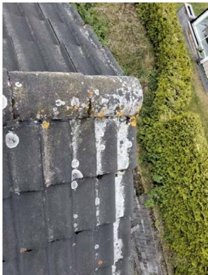
Det registreres noe mosevekst på taksteinen.
