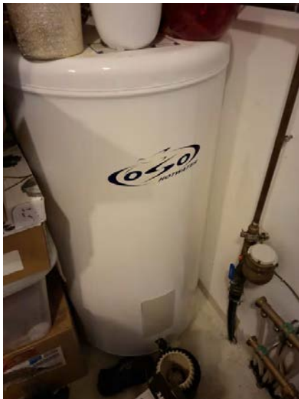
Varmtvannsbereder er plassert i teknisk rom.
