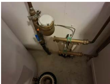
Hovedstoppekran er plassert på teknisk rom.
