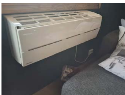
Varmepumpe i stue i underetasje.
