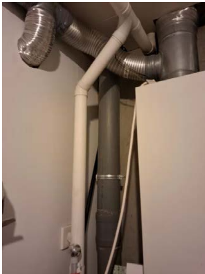
Synlige avløpsrør av plast i boligen.
