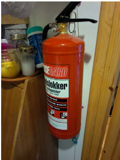
Eldre brannslukningsapparat plassert i teknisk rom.
