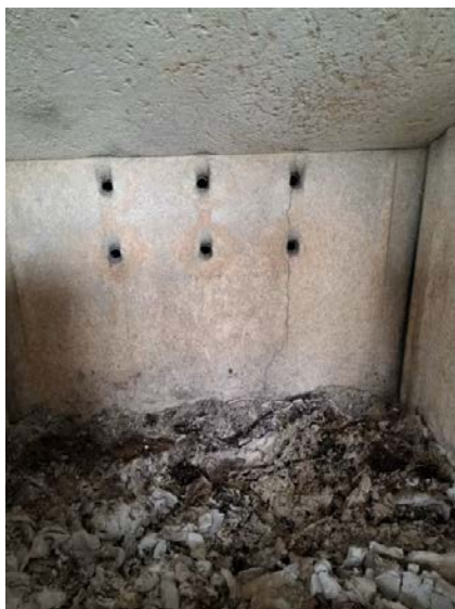
Det registreres en sprekk i ildfast stein i ovnen.
