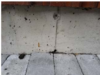
Det er mindre riss i grunnmuren.
