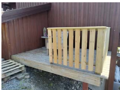
Terrassen mangler trapp med rekkverk.
