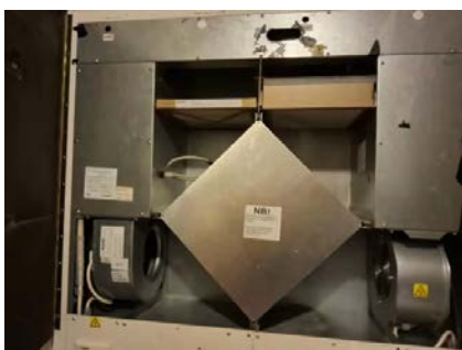
Ventilasjonsaggregat er plassert i teknisk rom.
