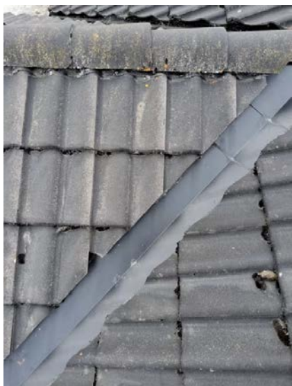
Det registreres enkelte knekte takstein ved gradrenne.
