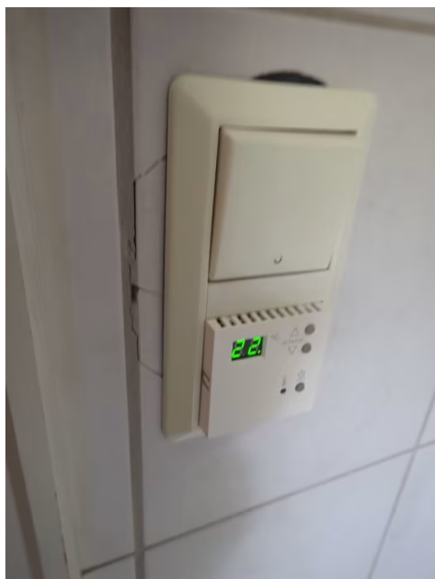
Sprekk i flis ved bryter.
