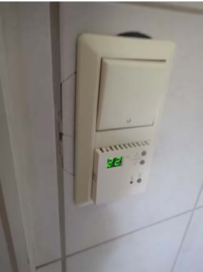
Sprekk i flis ved bryter.
