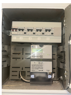
Sikringskap med automatsikringer.
