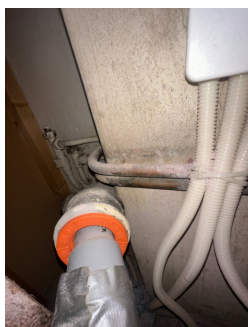
Tapet avløpsrør, eldre avløpsrør mot kjøkken
