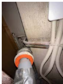
Tapet avløpsrør, eldre avløpsrør mot kjøkken
