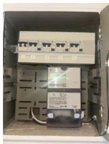
Sikringsskap med automatsikringer.
