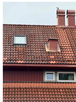
Bildet viser knekt takstein ved pipen.
