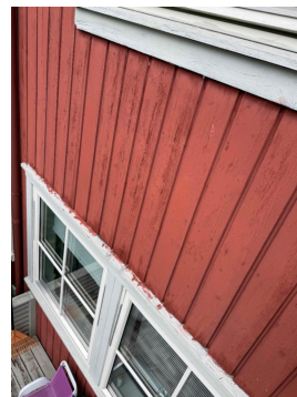
Bildet viser værslitt/oppsprukket trevirke/trepaneler.
