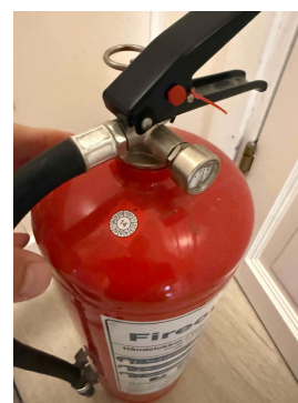
Bildet viser brannslukker datert 2014.
