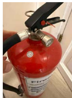
Bildet viser brannslukker datert 2014.
