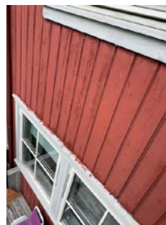
Bildet viser værslitt/oppsprukket trevirke/trepaneler.
