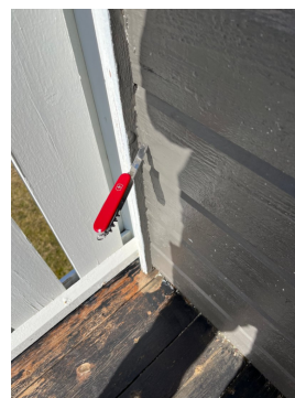
Tendens til råte i kledning på skillevegg.
