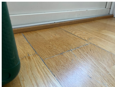
Skadet parkett ved terrassedør.
