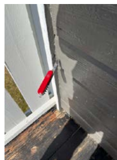
Tendens til råte i kleddning på skillevegg.
