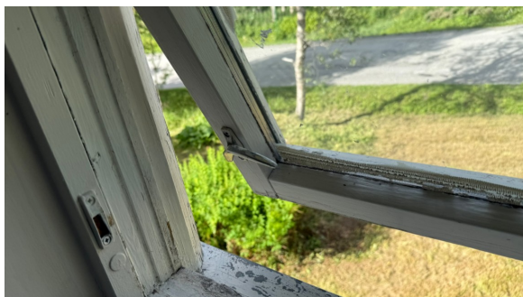
Eksempel på skade på vindu
