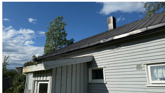
Eksempel på skader på takrenner.
