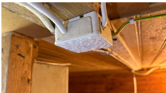
Eksempel på kondensering på overflater.
