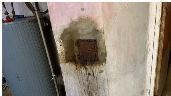
Sotluke med rust
