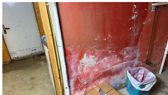
Fuktopptak i grunnmuren
