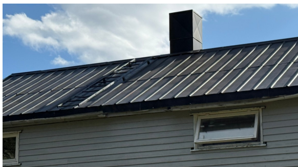
Takstigen er ikke tilstrekkelig festet til konstruksjonen.
