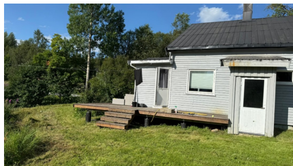
Manglende snøfangere på taket over veranda
