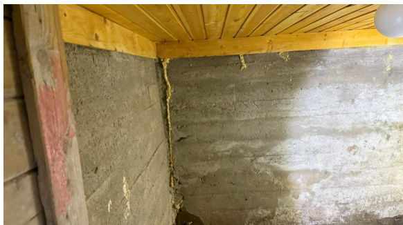
Eksempel på sprekker i grunnmuren
