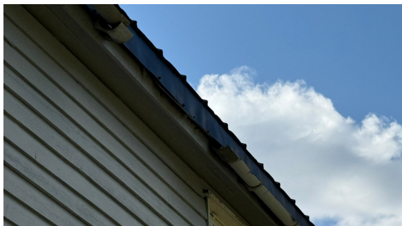
Eksempel på skader på takrenner.
