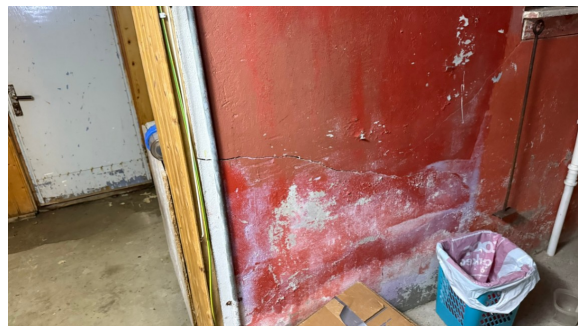
Eksempel på sprekker i grunnmuren.
