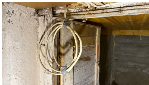
Eksempel på avvik på det elektriske anlegget
