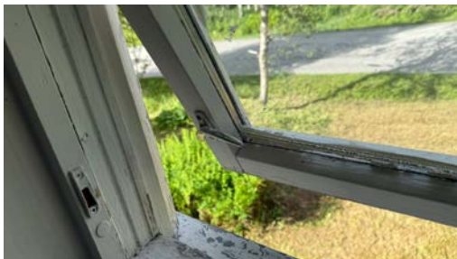
Eksempel på skade på vindu
