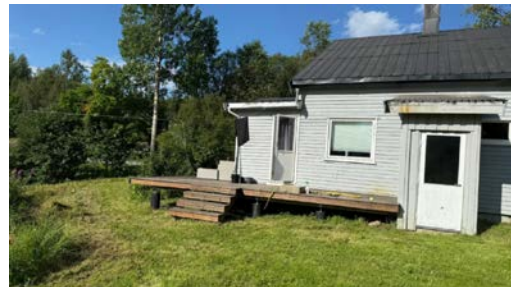
MAnglende snøfangere på taket over veranda
