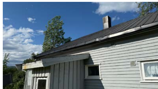
Eksempel på skader på takrenner.
