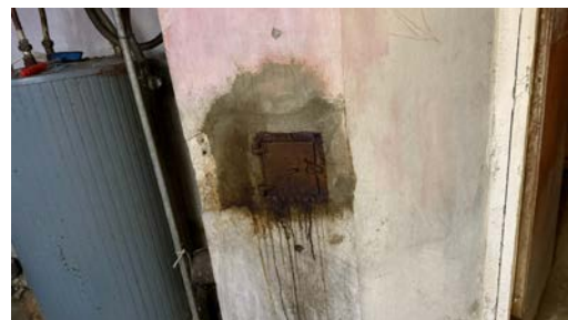
Sotluke med rust
