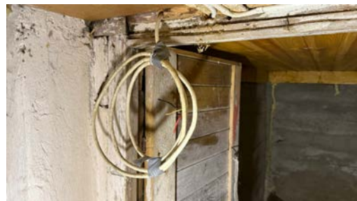
Eksempel på avvik på det elektriske anlegget
