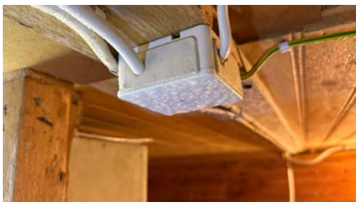
Eksempel på kondensering på overflater.
