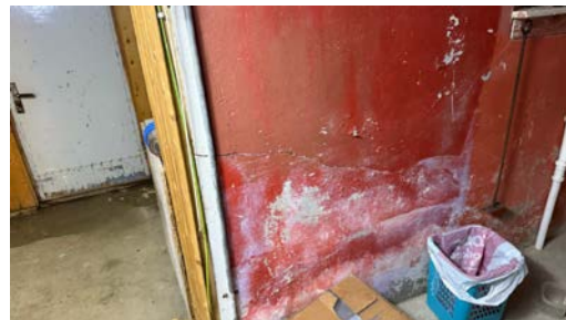
Fuktopptak i grunnmuren
