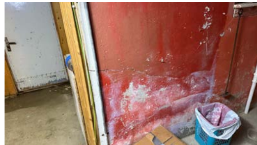
Eksempel på sprekker i grunnmuren.
