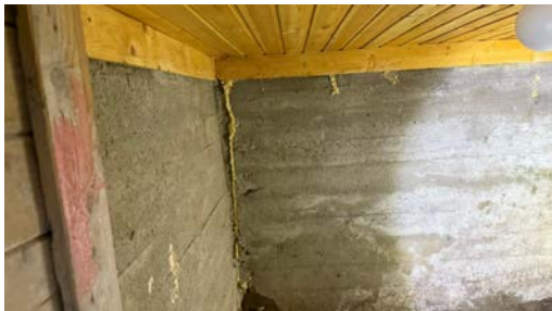
Eksempel på sprekker i grunnmuren
