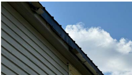
Eksempel på skader på takrenner.
