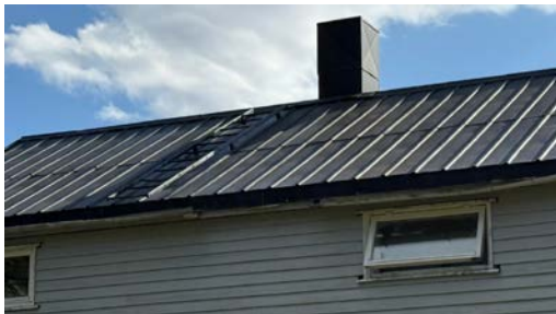
Takstigen er ikke tilstrekkelig festet til konstruksjonen.
