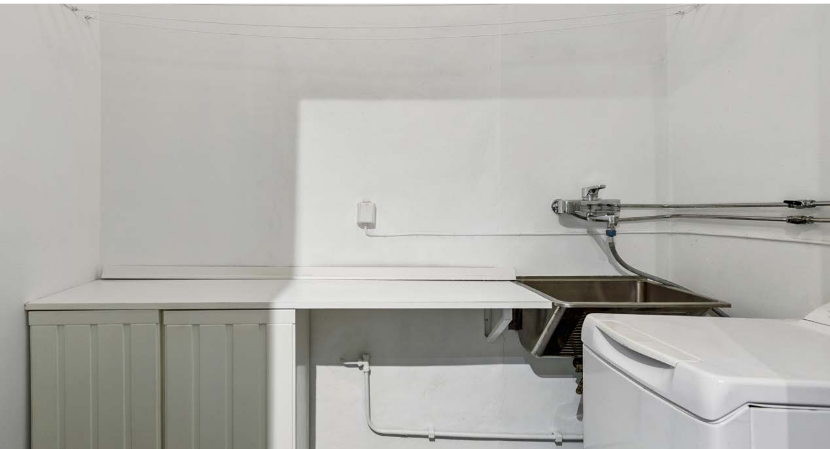
Vaskerom med benk med laminat benkeplate, stålvaske samt opplegg for vaskemaskin
