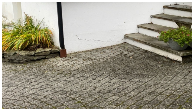
Riss i grunnmurspuss.
