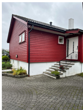
Sprekk etter setning i entrétrapp
