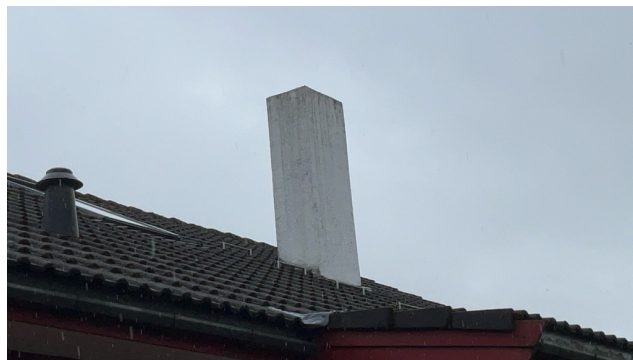
Pipe over tak
