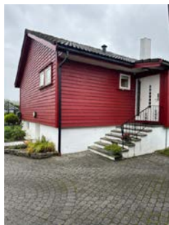
Sprekk etter setning i entrétrapp
