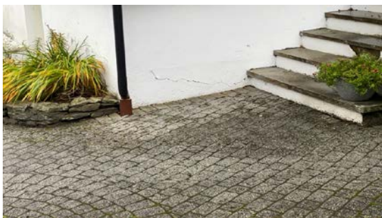
Riss i grunnmurspuss.
