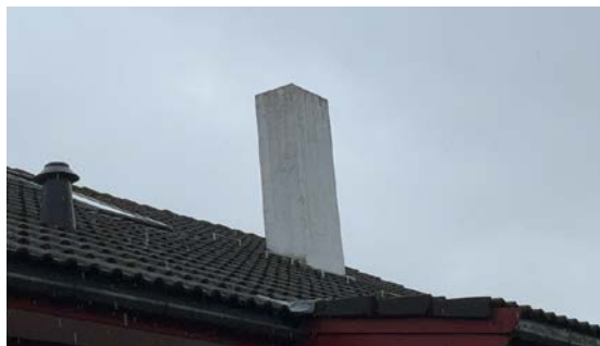
Pipe over tak
