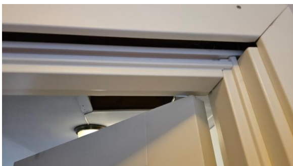
Mangler foring på soberomdør.
