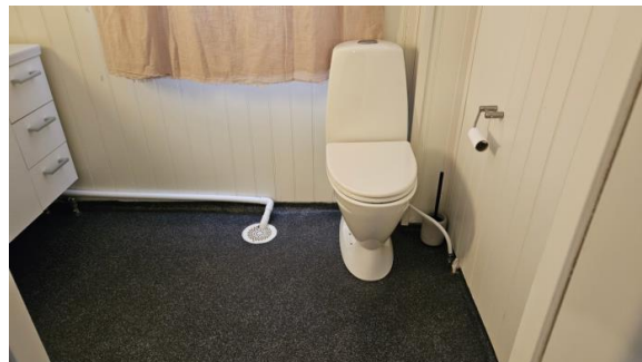
Toalett ikke tilstrekkelig festet
