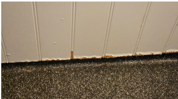
Fuktsvell i plater ved gulv og servant.
