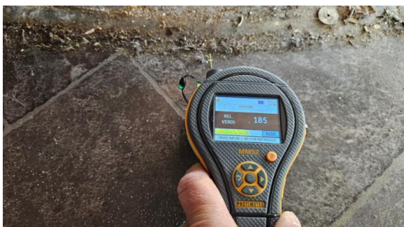
Det ble fuktmålt ved befaring, noe forhøyede verdier ble registrert.
