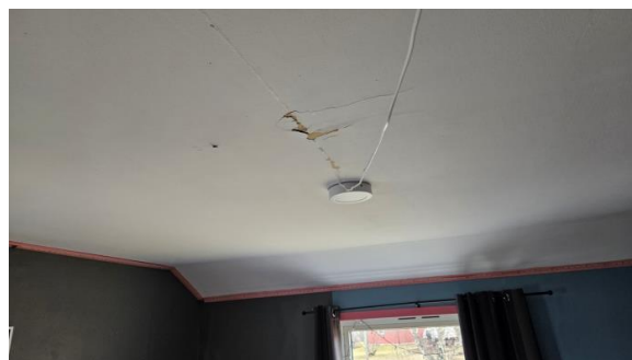
Skade i malerpapp.
