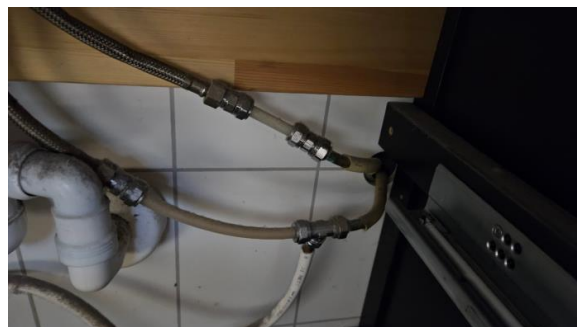
Ufagmessig utførelse på rørgjennomføring i servantskap.
