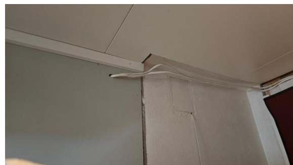
El-kabler ikke tilstrekkelig festet ved pipe i gang.
