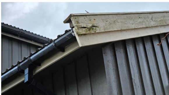
Råteskade i vindskibord.
