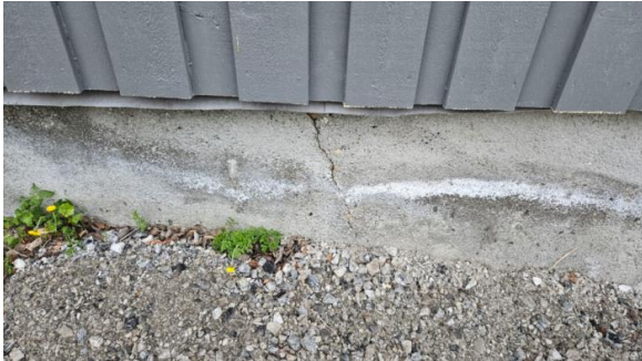
Sprekk/riss i grunnmur.
