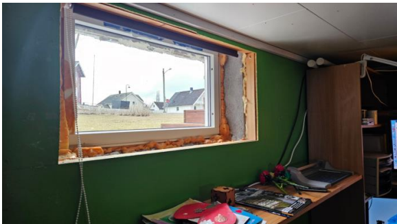
Vindu i kjellerstue er ikke foret ut og listet.
