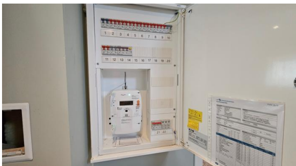
Kontroll av sikringsskap
