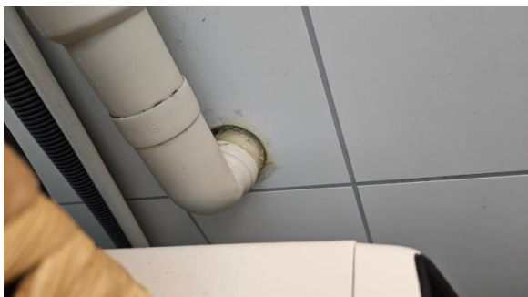
Misfarget fuge rundt avløpsrør.
