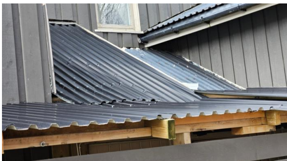
Det er manglende takrenne og nedløp ved inngangsparti til kjeller.
