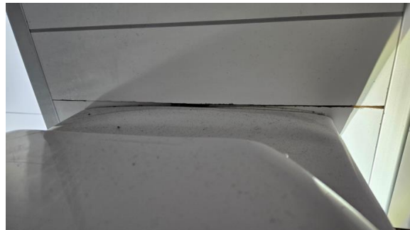
Det er skjøt på toalett kasse, plate glipper ut over toalett.
