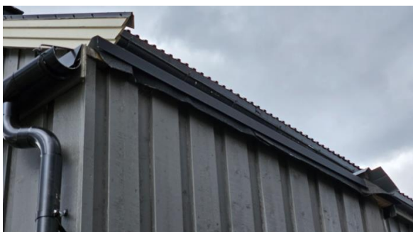
Ufagmessig utførelse på avslutning av papp og beslag på takterrasse.
