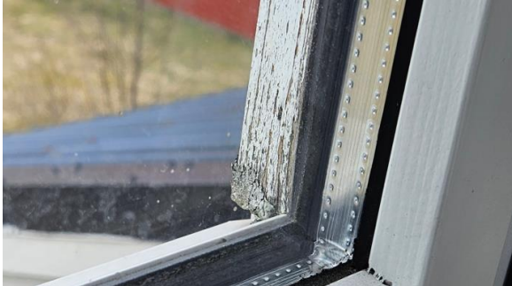
Vindu bad/wc/vaskerom har punktert glass.
