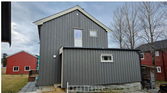
Det er ikke montert rekkverk på takterrasse.
