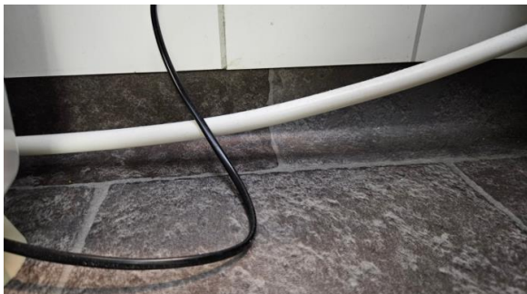
Det er ikke montert sokkel lister på badromsplater.
