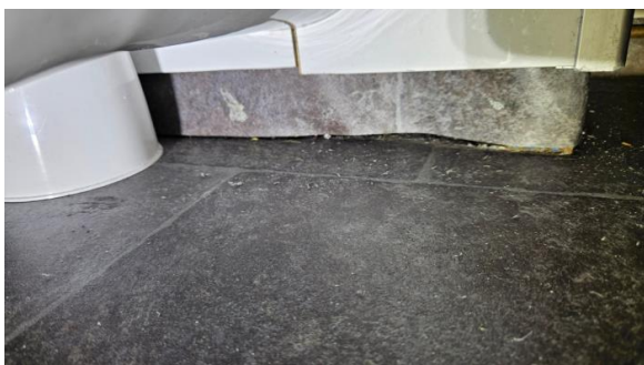
Kontroll drenering fra toalett kasse, belegg buler noe inn.
