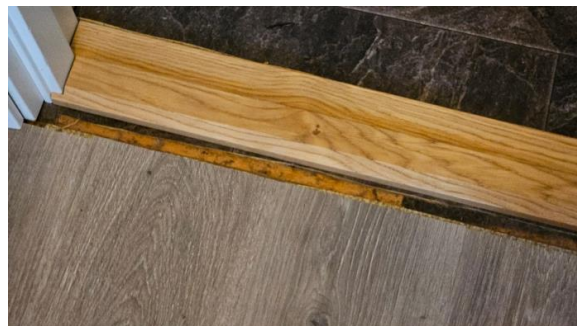
Det er ikke montert overgangs lister mot dørterskler.
