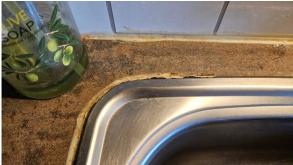
Fuktsvell og fuge som er løsnet.
