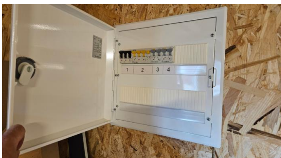
Sikringsskap i garasje.
