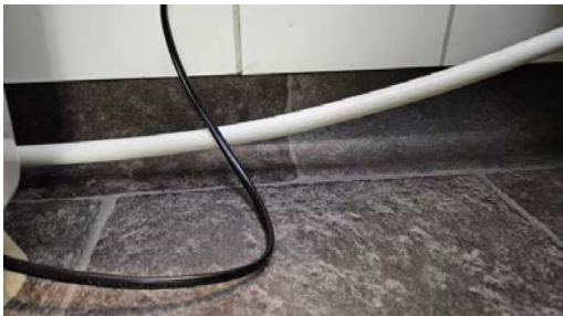
Det er ikke montert sokkel lister på baderomsplater.
