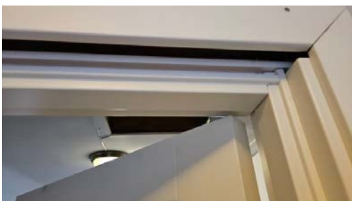
Mangler foring på soveromsdør.
