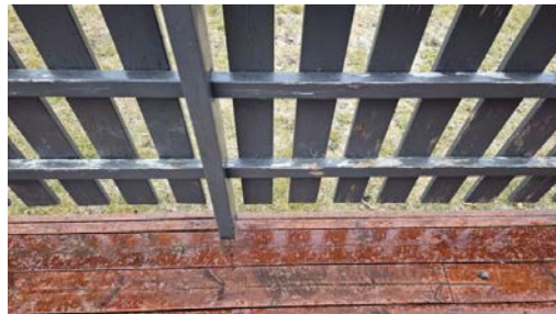
Malings avflassing av rekkverk
