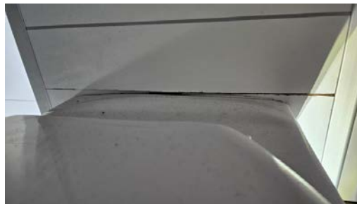
Det er skjøt på toalett kasse, plate glipper ut over toalett.
