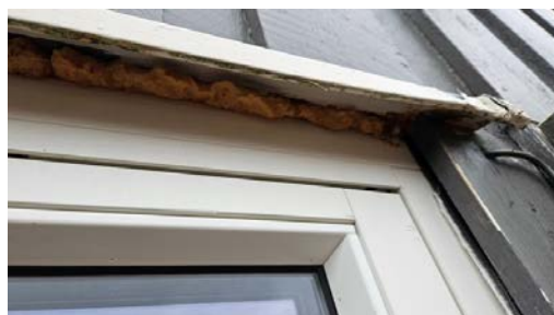
Ufagmessig tettet rundt vindu.
