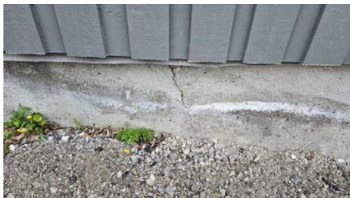
Sprekk/riss i grunnmur.
