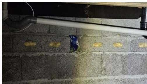
Veggventil er tettet.
