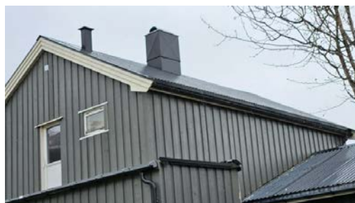
Det er en del ned bøyning av takrenne (på grunn av takras).
