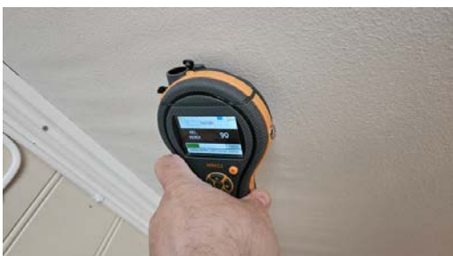
Det er registrert fuktsvell i tak ved pipe på kjøkken. det ble ved befarings fuktmålt, ingen forhøyede verdier ble registrert.
