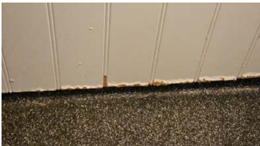
Fuktsvell i plater ved gulv og servant.
