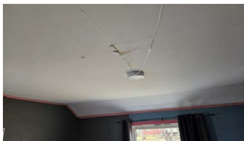
Skade i malerpapp.
