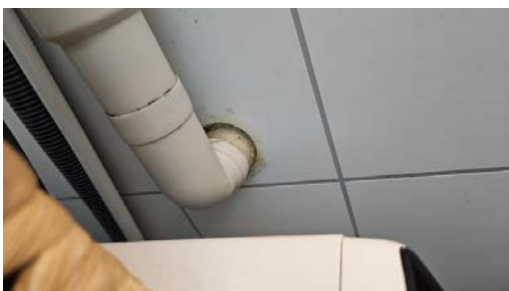
Misfarget fuge rundt avløpsrør.
