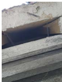
Det er ikke montert musebånd/ lusing bak kledning.
