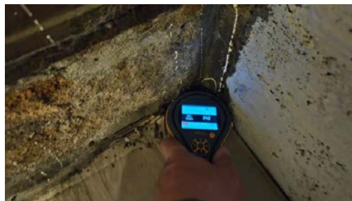
Det ble ved befarings fuktmålt under sotluke, forhøyede verdier ble registrert.
