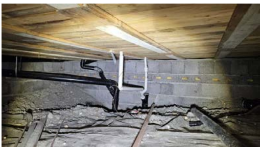
Avløpsrør fra bad. Fuktsperre er delvis fjernet.
