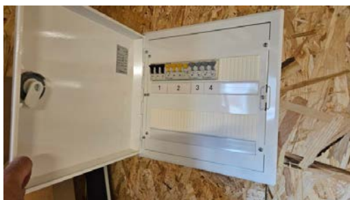
Sikringsskap i garasje.
