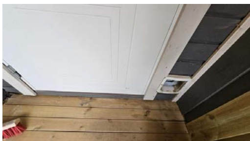
Småskader i hovedinngangsdør.
