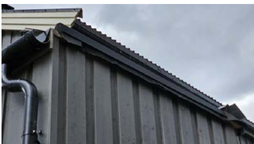
Ufagmessig utførelse på avslutning av papp og beslag på takterrasse.
