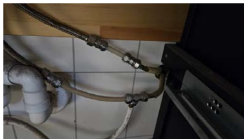
Ufagmessig utførelse på rørgjennomføring i servantskap.
