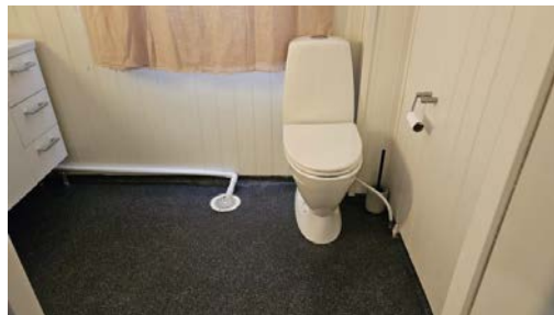
Toalett ikke tilstrekkelig festet
