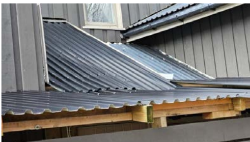
Det er manglende takrenne og nedløp ved inngangsparti til kjeller.
