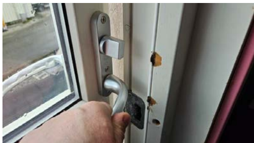
Balkongdør subber i karm og har skade i karm.
