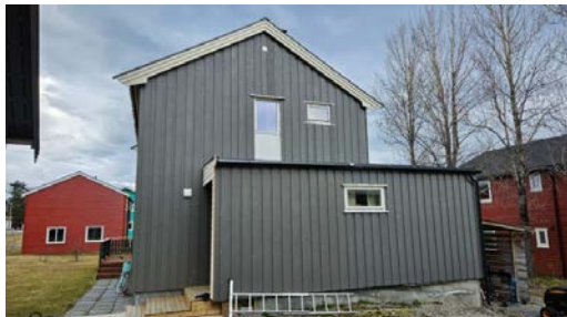
Det er ikke montert rekkverk på takterrasse.
