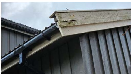
Råteskade i vindskibord.
