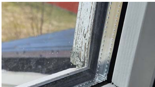
Vindu bad/wc/vaskerom har punktert glass.
