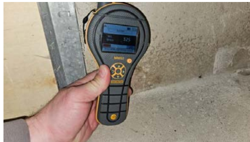
Kontroll av fuktmåling i tilstøtende rom (vaskerom), her ble forhøyede verdier registrert.
