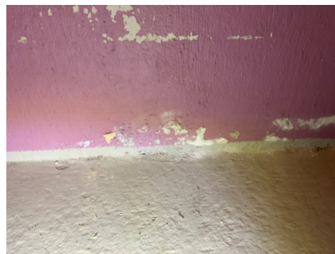
Saltutslag i vegger
