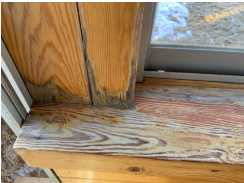
Fuktmerker i treverk.
