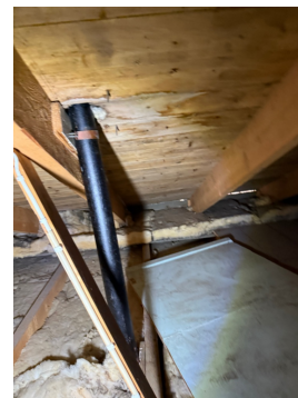
Fuktmerker ved gjennomføring av luftekanal.
