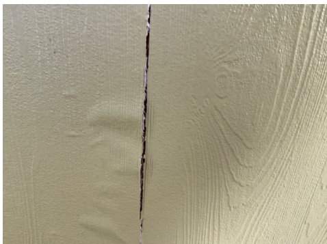
Sprekk i veggplate i vindfang
