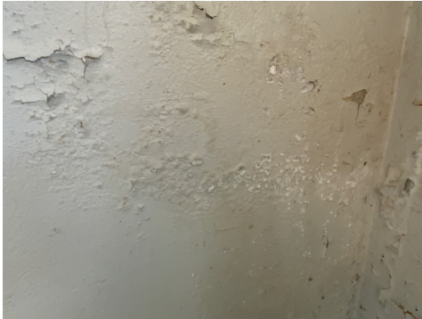
Saltutslag på vegger i kjeller
