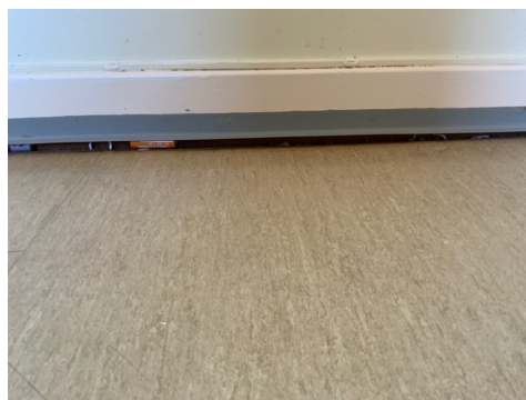
Åpninger ved gulvlist på soverom.
