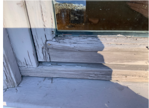
Råteskade i stuevindu
