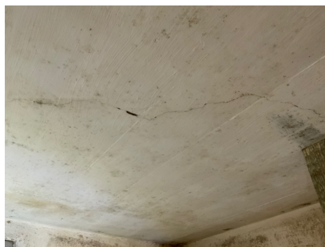
Sprekk i etasjeskiller.
