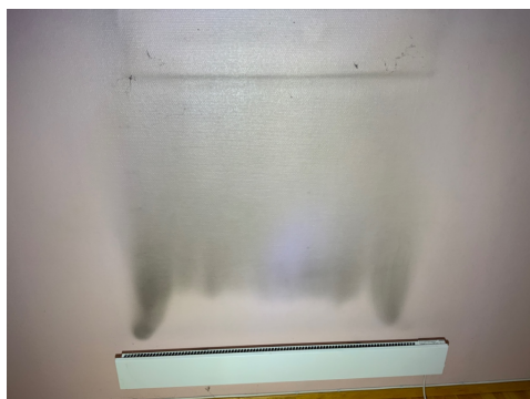
Veggplater er misfarget i kjellerstue.
