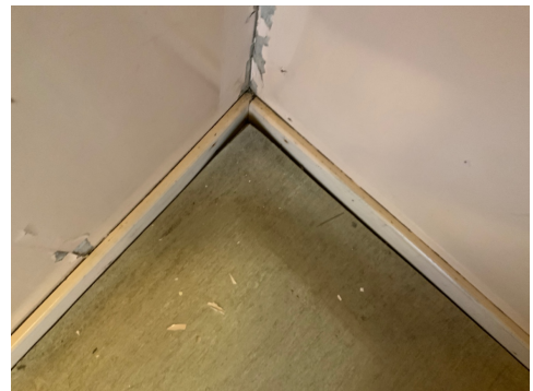
Gulvbelegg løsnet i hjørnet
