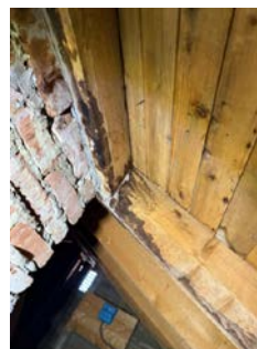
Fuktmerker i konstruksjonene ved gjennomføring til pipe på kaldloft.
