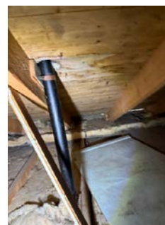
Fuktmerker ved gjennomføring av luftekanal.
