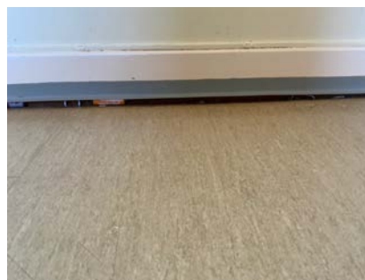
Åpninger ved gulvlist på soverom.
