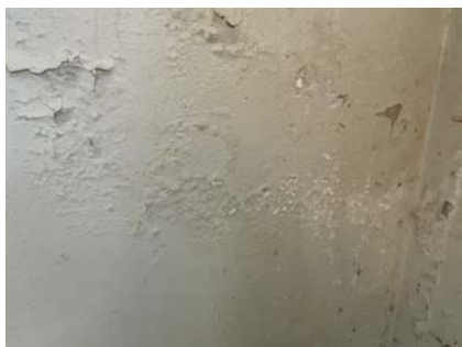
Saltutslag på vegger i kjeller
