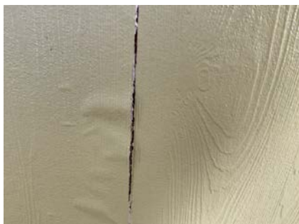
Sprekk i veggplate i vindfang
