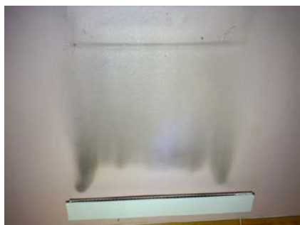
Veggplater er misfarget i kjellerstue.
