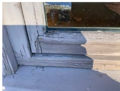
Råteskade i stuevindu
