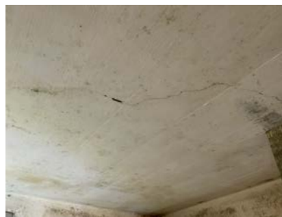
Sprekk i etasjeskiller.
