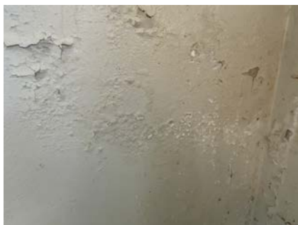
Saltutslag på vegger i kjeller
