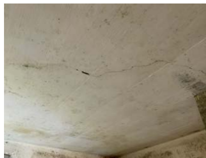
Sprekk i etasjeskiller.
