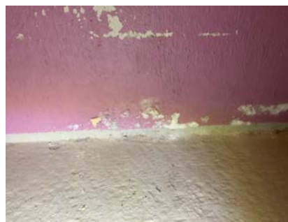
Saltutslag i vegger
