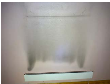
Veggplater er misfarget i kjellerstue.
