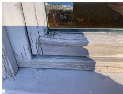
Råteskade i stuevindu
