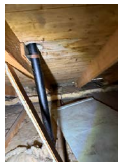
Fuktmerker ved gjennomføring av luftekanal.
