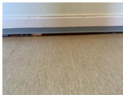
Åpninger ved gulvlist på soverom.
