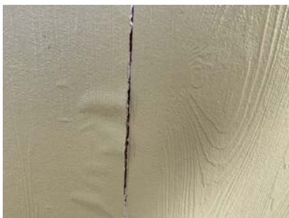
Sprekk i veggplate i vindfang
