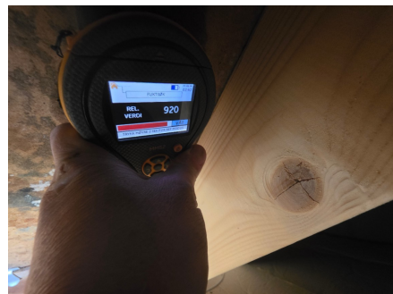
Overflate søk viser tegn til vedvarende fukt i undertaket.
