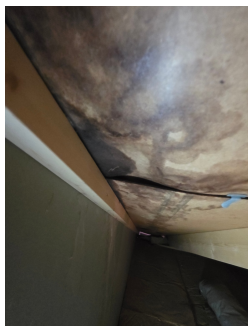
Fukt i undertak ved brannskille vegg mot felles inngang.
