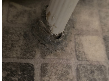
Rørføring for toalett er ikke tett.
