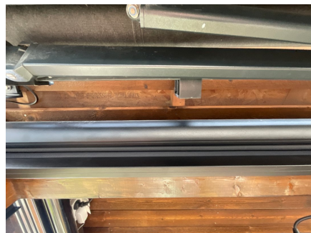
Luftespalte ved raft.
