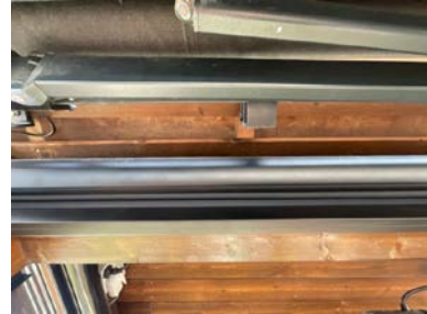
Luftespalte ved raft.
