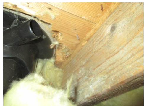
Fuktmåling i underliggende åpen himling.
