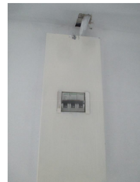
Inntaket på ene soverommet på loftet.
