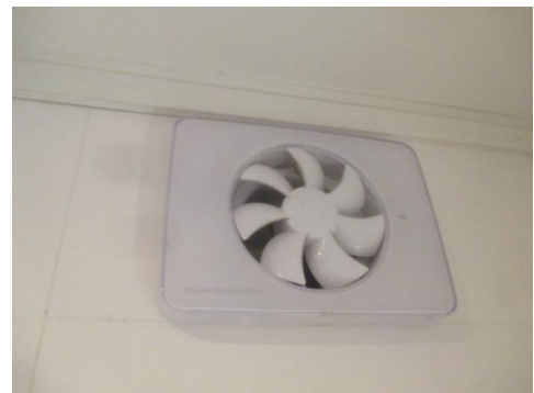
Vifte i ytterveggen.
