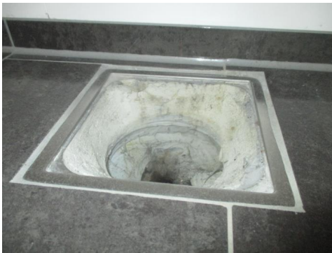
Sluk under innredning.
