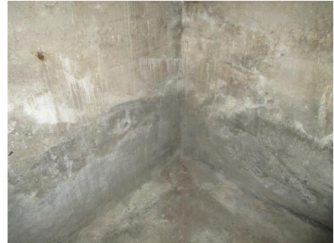
Fuktmerker og noe fuktvandring i grunnmur.
