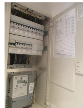
Sikringsskapet er plassert i gangen på loftet.
