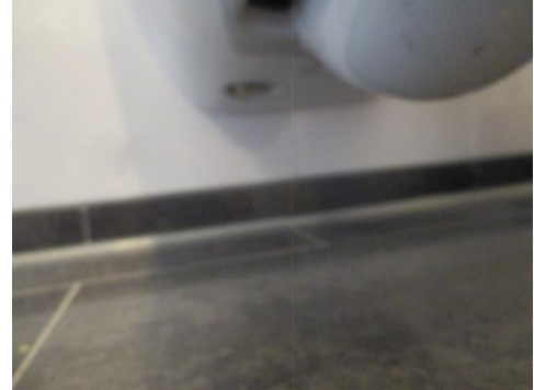
Ingen hull for synliggjøring av lekkasjevann.
