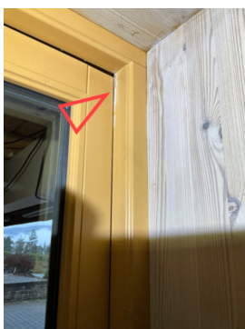
Dørblad på balkongdør i stue tar i karm, dette har ført til skade i overflatebehandlingen
