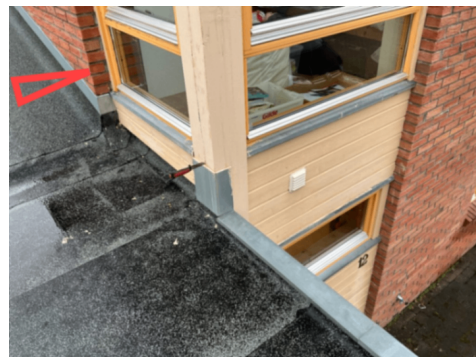
Værslitt overflatebehandling på vindu
