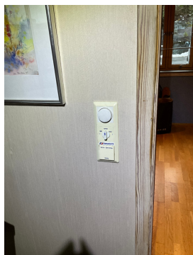
Styringspanel for ventilasjon, plassert på vegg i spisestue.
