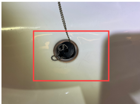
Riss i overflate rundt sluk i servant
