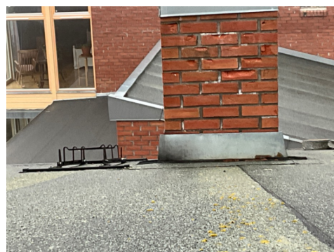
Avskalling på murstein på pipe over tak.
