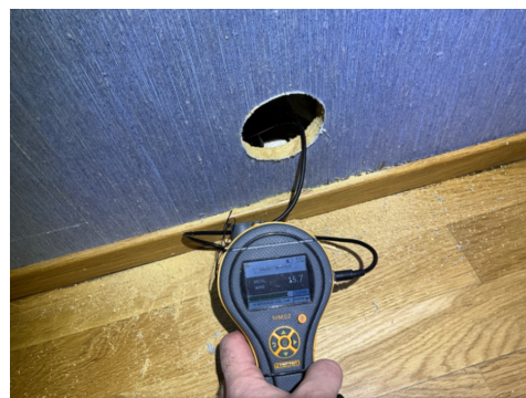
Fuktmåling med pigg viser 15,7%fukttinnhold i trevirke
