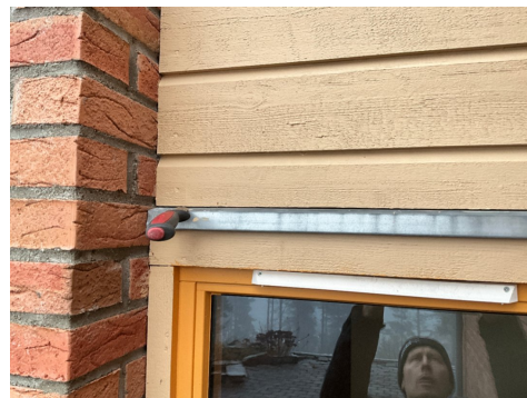
Liten avstand mellom kledning og beslagsdetaljer over vindu i spisestue
