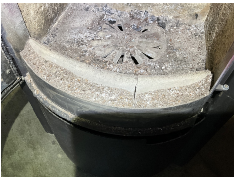
Sprekk i ildfast stein i vedovn
