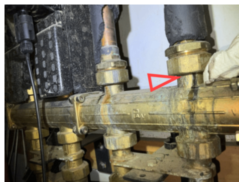
Drypplekasje på samlestokk til varmeanlegg
