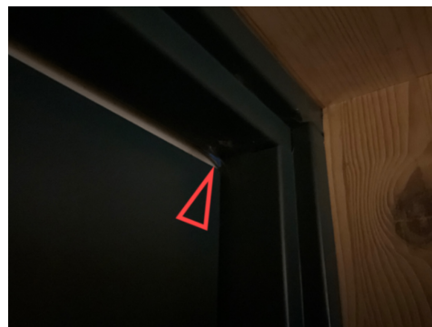
Glippe mellom dørblad og karm på hovedinngangsdør
