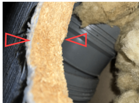
Veggplate i soverom på vegg mot bad har svellet
