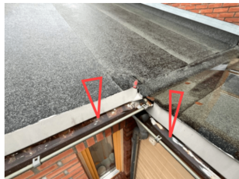
Rust i takrenner
