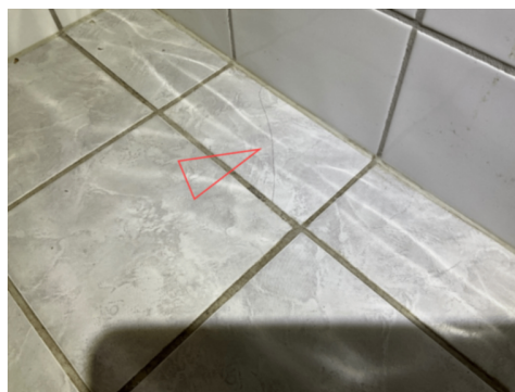
Sprekk i gulvflis
