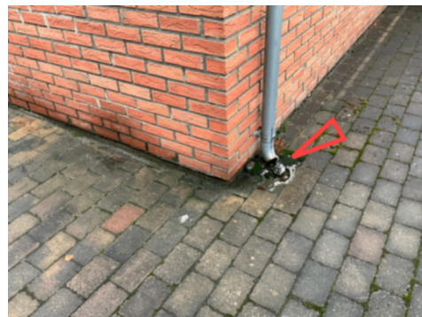
Takvann slippes på terreng
