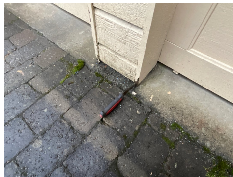
Tilløp til råteskade i bunn på trekledning
