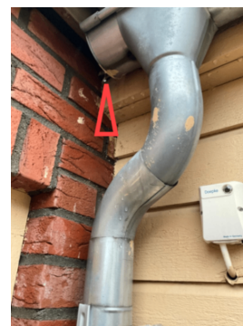
Registrert punktvis lekkasjer i takrenner
