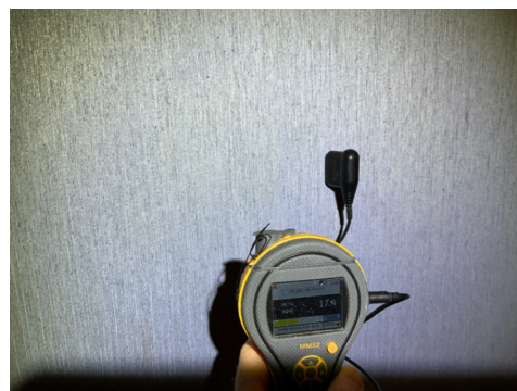
Fuktmåling med pigg viser 17,4%fukttinnhold i veggplate
