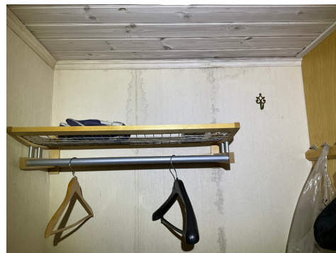
Fuktskader på vegg i vindfang
