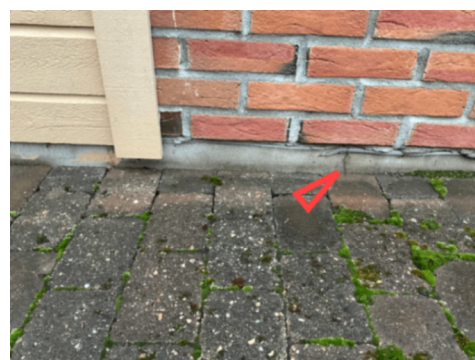
Sprekk i grunnmur
