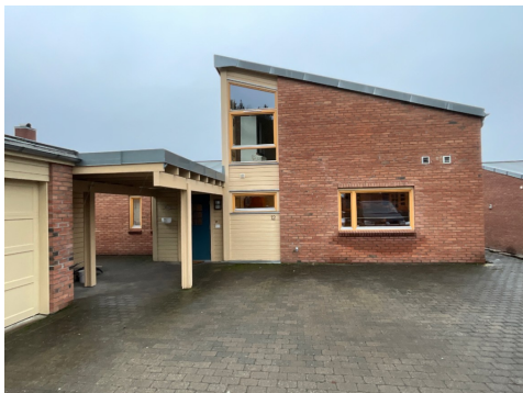
Noe saltutslag på murfasade
