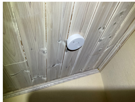
Røykvarsler i loftsetasjen
