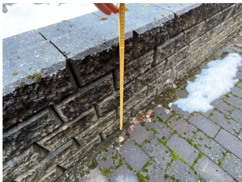
Høydeforskjell større enn 0,5 meter
