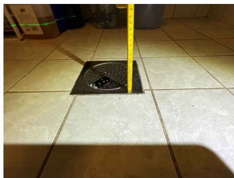
Måling av høydeforskjell på gulv. Topp laserstrek viser 80mm, målt høydeforskjell på 5mm fra gulv ved dørterskel til topp sluk.
