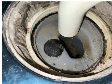
Sluk under dusjkabinett
