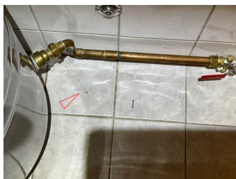
Sprekk i gulvflis
