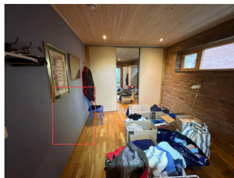
Skade på vegg i soverom mot sør i 1.etasje
