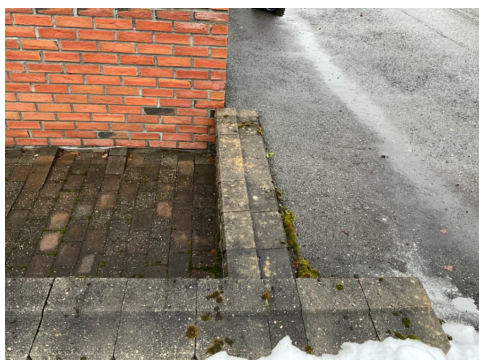
Registrert mindre skjevheter i forstøtningsmur
