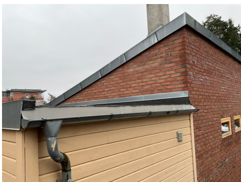
Saltutslag på murfasader
