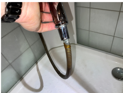
Skade på slange til hånddusj i dusjkabinett
