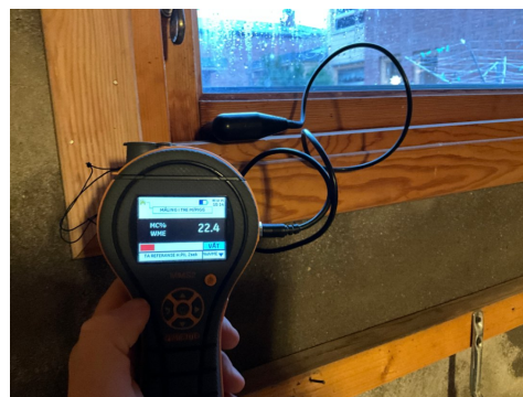
Registrert 22,4% fuktinnhold i trevirke på vindu ved fuktmåling med pigg.
