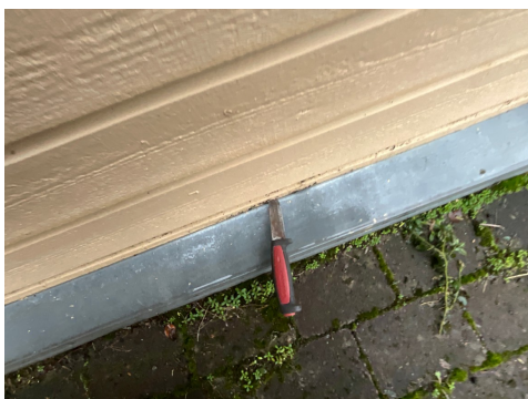
Liten avstand mellom kledning og beslagsdetaljer, dette har ført til råteskade i kledningsbord ved hovedinngang.
