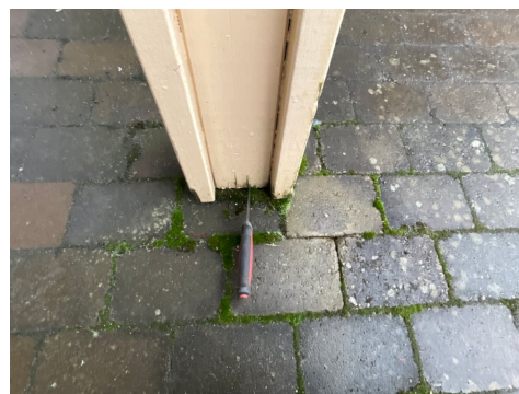
Tilløp til råteskade i bunn på søyler, søyle står ganske tett ned til terreng/belegningsstein.
