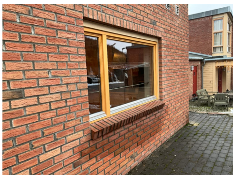
Værslitt overflatebehandling på vindu
