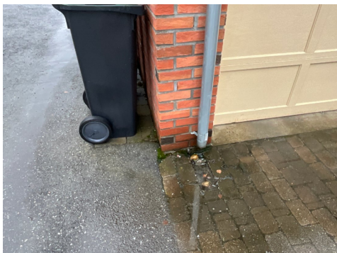
Vannansamling ved taknedløp
