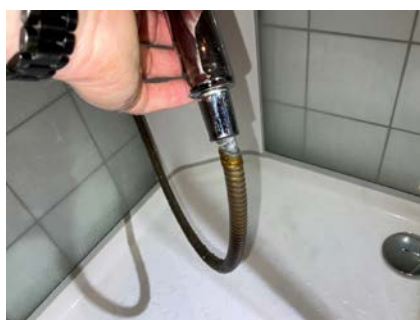
Skade på slange til hånddusj i dusjkabinett
