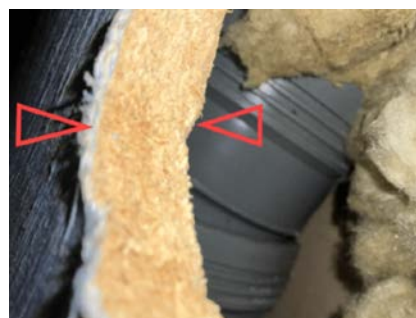
Veggplate i soverom på vegg mot bad har svellet
