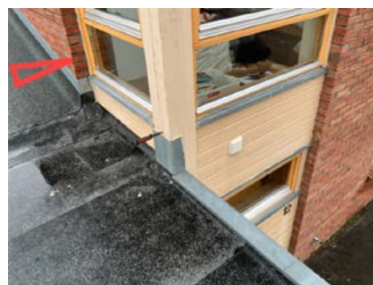
Værslitt overflatebehandling på vindu
