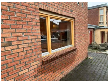
Værslitt overflatebehandling på vindu
