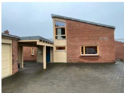
Noe saltutslag på murfasade
