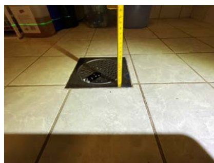
Måling av høydeforskjell på gulv. Topp laserstrekk viser 80mm, målt høydeforskjell på 5mm fra gulv ved dørterskel til topp sluk.
