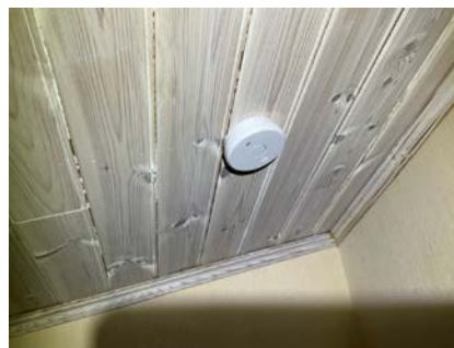
Røykvarsler i loftsetasjen
