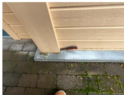
Råte i bunn på hjørnebord ved hovedinngang
