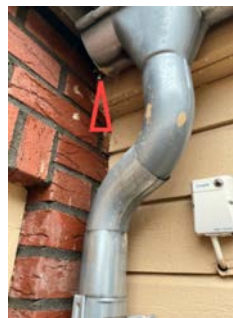
Registrert punktvis lekkasjer i takrenner
