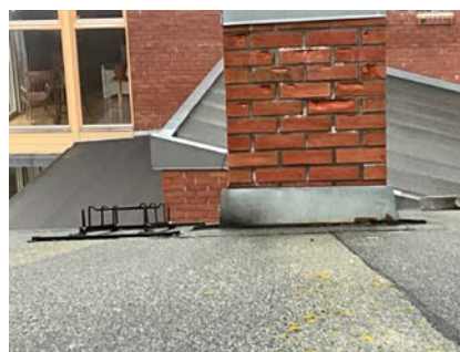
Avskalling på murstein på pipe over tak.
