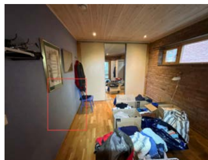
Skade på vegg i soverom mot sør i 1.etasje
