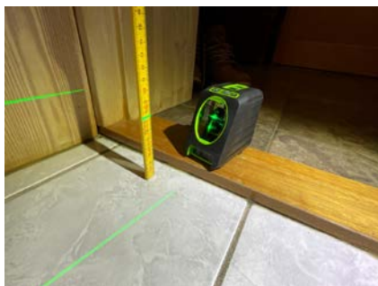
Måling av høydeforskjell på gulv. Topp laserstrek viser 75mm
