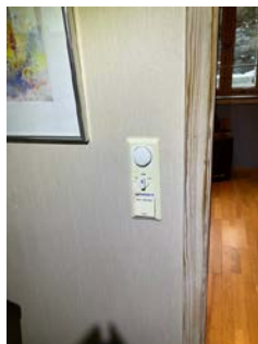
Styringspanel for ventilasjon, plassert på vegg i spisetue.
