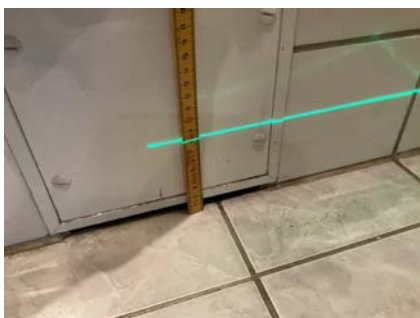
Måling av høydeforskjell på gulv. Topp laserstrek viser 82mm. Høydeforskjell på 3mm fra gulv ved dør til topp sluk ved badekar.
