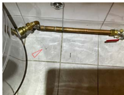
Sprekk i gulvflis
