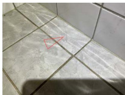
Sprekk i gulvflis
