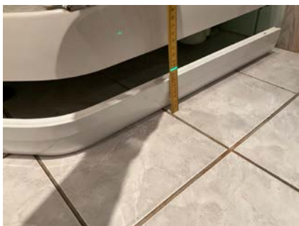
Måling av høydeforskjell på gulv. Topp laserstrek viser 79mm.
