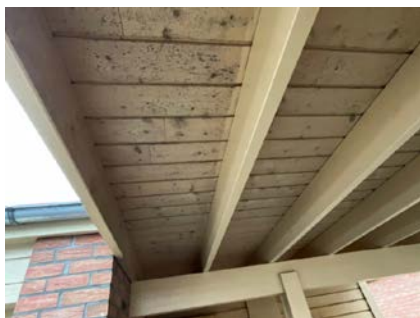
Det registreres svertesopp på undersiden av undertak i svalgang
