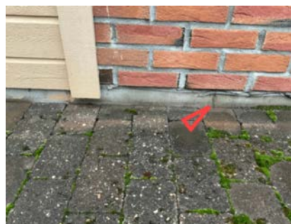
Sprekk i grunnmur
