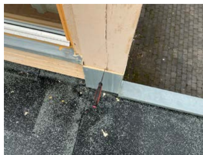
Tilløp til råte i søyle mellom vinduer på hjørne mot sør-øst.
