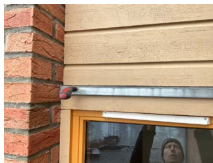
Liten avstand mellom kledning og beslagsdetaljer over vindu i spisestue
