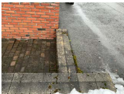
Registrert mindre skjevheter i forstøtningsmur
