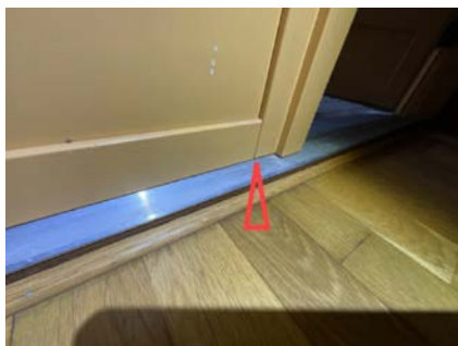
Sidedør på tofløyet balkongdør i soverom tar i terskel, sidedør lar seg heller ikke låse i terske
