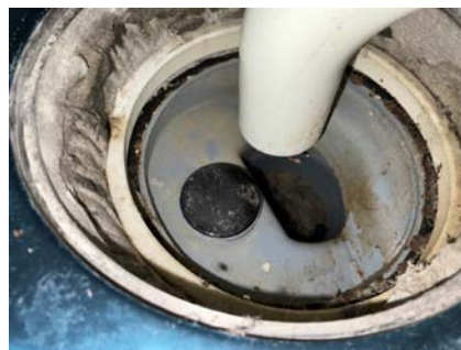
Sluk under dusjkabinett
