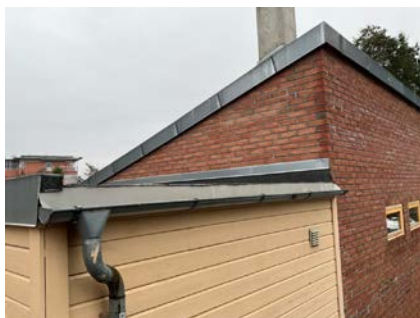
Saltutslag på murfasader
