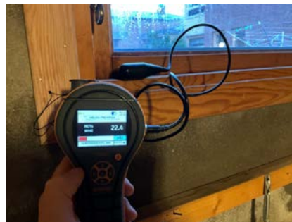
Registrert 22,4% fuktnivå i trevirke på vindu ved fuktmåling med pigg.
