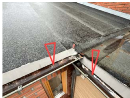
Rust i takrenner
