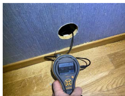
Fuktmåling med pigg viser 15,7%fuktnnhold i trevirke
