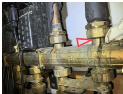
Drypplekasje på samlestokk til varmeanlegg
