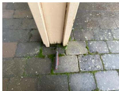
Tilløp til råteskade i bunn på søyler, søyle står ganske tett ned til terreng/belegningsstein.
