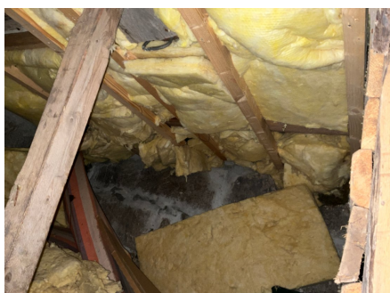
Mangler isolasjon i deler av etasjeskille.
