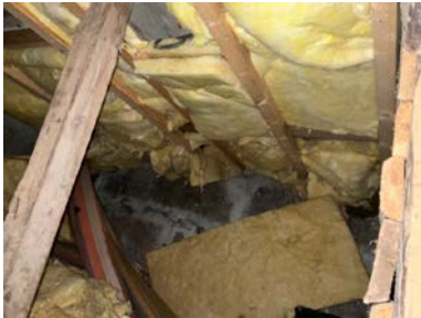
Mangler isolasjon i deler av etasjeskille.
