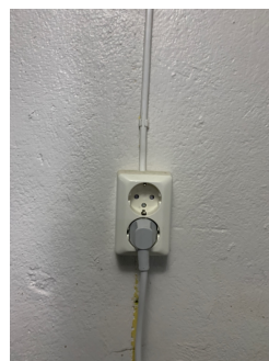
Stikkontakt tilkobling er ikke forskriftsmessig
