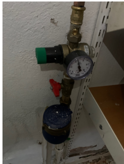
Nyere stoppekran. Fungerer som tiltenkt.
