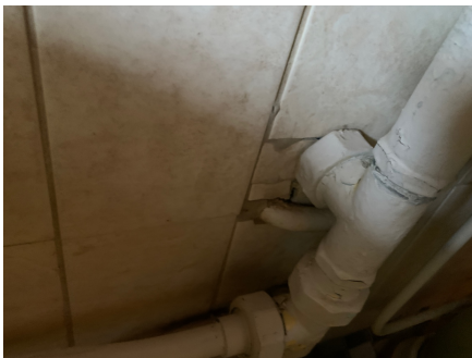
Rørgjennomføring uten mansjett
