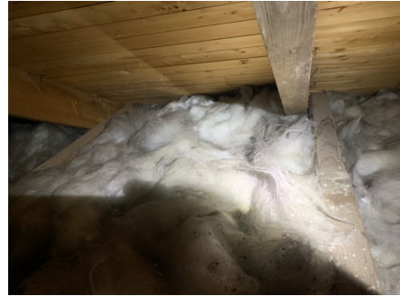
Isolasjon ført helt mot undertak. Ingen synlig lufting av konstruksjonen
