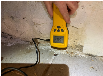
Høye fuktsøkverdier nederst på vegger
