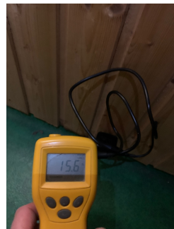
Fuktverdi i trevirke i badstuen i grenseland
